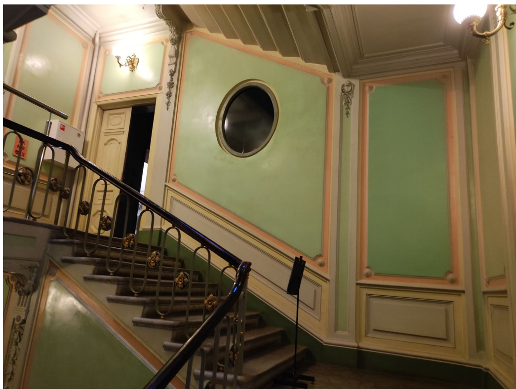
9. Лестница корпуса по Галерной улице. Вид маршей, ведущих с 1-го на 2-й этаж и междуэтажной площадки 2-го этажа.
