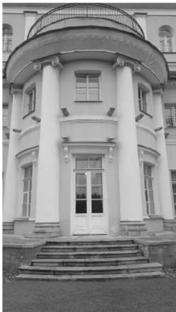
Фото 50. Фрагмент фасада (со стороны усадебного сада) в осях 1-17. Полуциркульный ризалит, балкон. Карнизы 2-3 этажей закрыты строительной сеткой.
