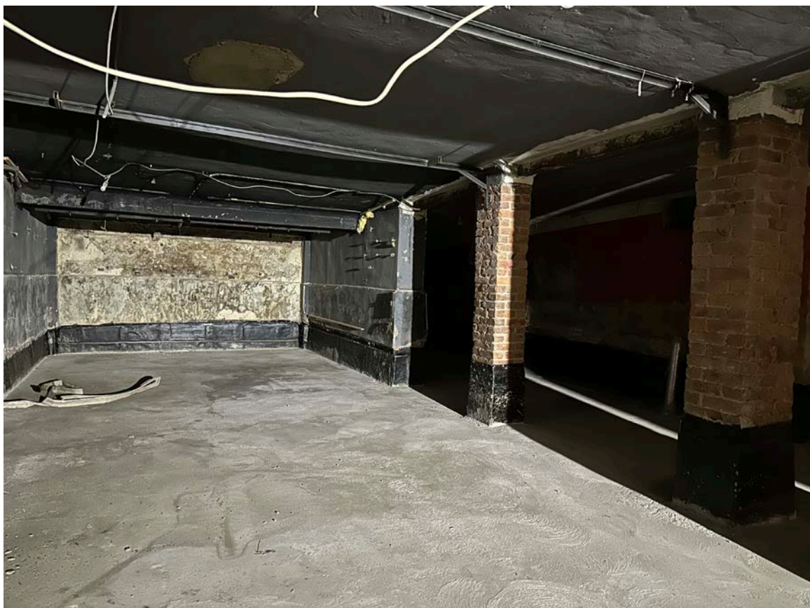
Фото 13. Интерьер объекта культурного наследия регионального значения «Дом просветительских учреждений в память 19 февраля 1861 года», подвальный этаж
