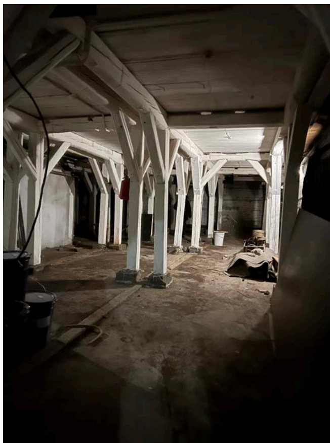
Фото 21. Интерьер объекта культурного наследия регионального значения «Дом просветительских учреждений в память 19 февраля 1861 года», подвальный этаж
