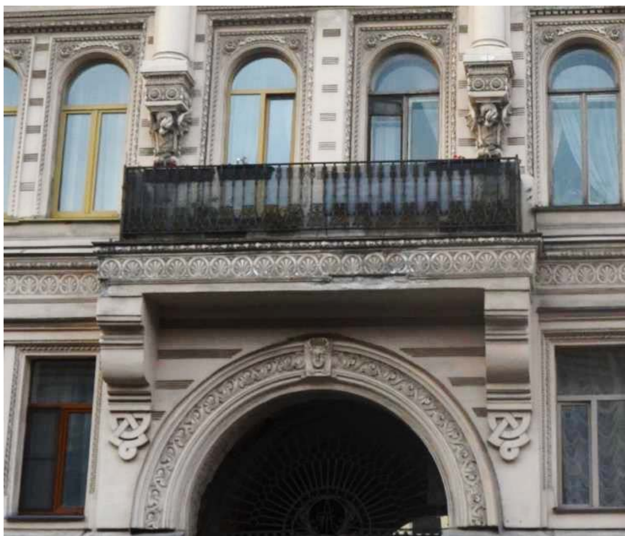
27. Выявленный объект культурного наследия «Дом Косиковского (А.М.Тупикова)». Оформление балкона в уровне третьего этажа по центральной оси южного лицевого фасада. Вид с юга. Съемка 26.04.2021
