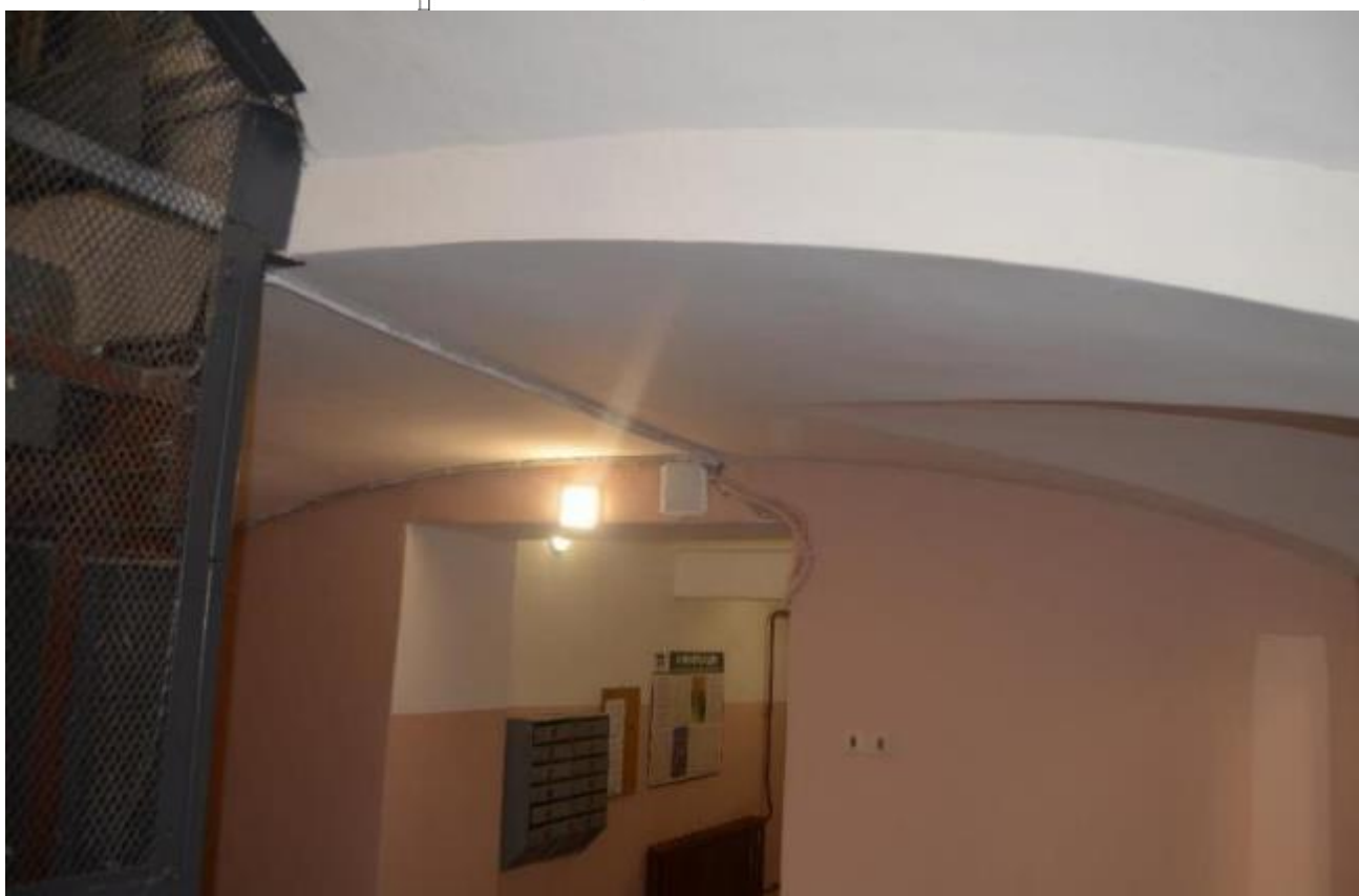
43. Выявленный объект культурного наследия «Дом Косиковского (А.М.Тупикова)». Свод лестничных площадок парадной лестницы восточного лицевого фасада (ЛК 1) в уровне первого этажа. Вид с запада. Съемка 26.04.2021
