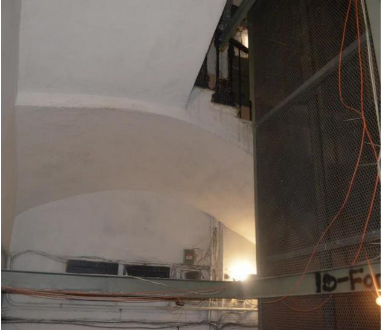
59. Выявленный объект культурного наследия «Дом Косиковского (А.М.Тупикова)». Черная лестница северного дворового фасада (ЛК 3). Конструкция маршей. Вид с северо-запада. Съемка 26.04.2021
