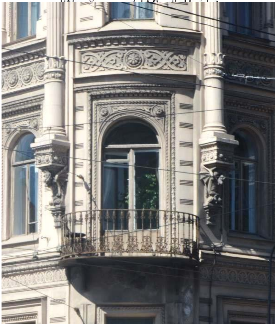
31. Выявленный объект культурного наследия «Дом Косиковского (А.М.Тупикова)». Оформление скошенного угла между лицевыми фасадами в уровне третьего этажа, включая закругленный балкон. Вид с юго-востока. Съемка 26.04.2021
