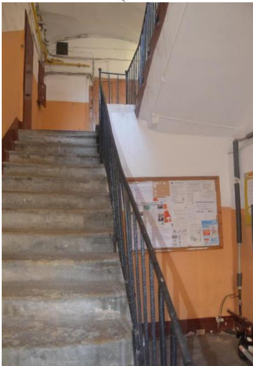
56. Выявленный объект культурного наследия «Дом Косиковского (А.М.Тупикова)». Черная лестница западного дворового фасада (ЛК 2). Вид с запада. Съемка 26.04.2021
