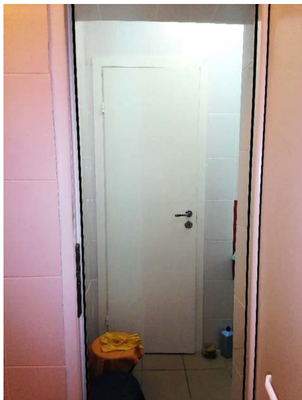
Фото 42. Здание детского отделения городской поликлиники №27. Санитарные комнаты Пом.32,33 (1-Н). 12.10.2022г.
