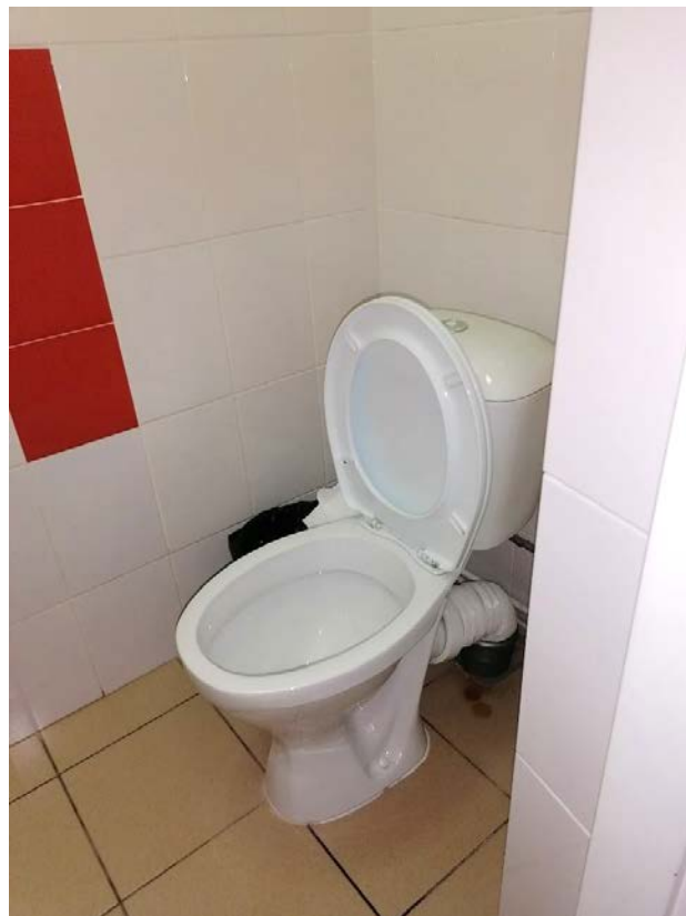
Фото 41. Здание детского отделения городской поликлиники №27. Санитарные комнаты. Пом.34 (1-Н). 12.10.2022г.
