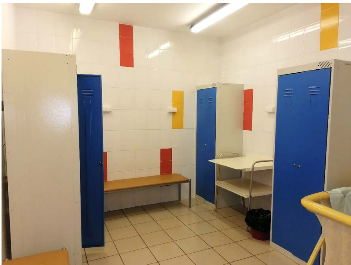
Фото 48. Здание детского отделения городской поликлиники №27. Раздевалка лечебного бассейна на первом этаже. Пом.20 (1-Н). 12.10.2022г.
