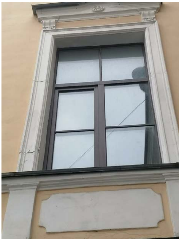
Фото 24. Здание детского отделения городской поликлиники №27. Состояние отделки оконного проема второго этажа западного дворового фасада. 12.10.2022г.
