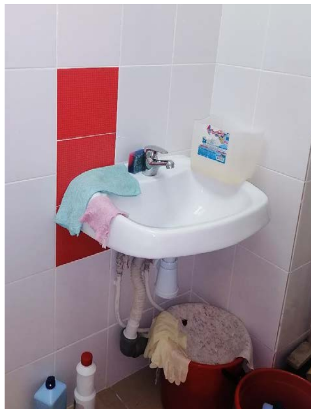
Фото 43. Здание детского отделения городской поликлиники №27. Санитарные комнаты. Пом.32 (1-Н). 12.10.2022г.
