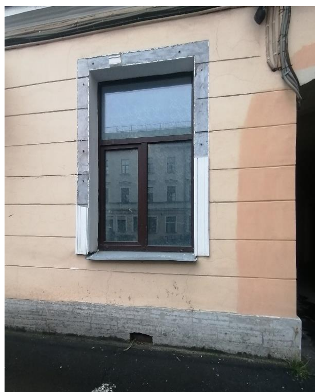
Фото 21. Здание детского отделения городской поликлиники №27. Состояние отделки оконного проема первого этажа западного дворового фасада у воротного проема. 12.10.2022г.
