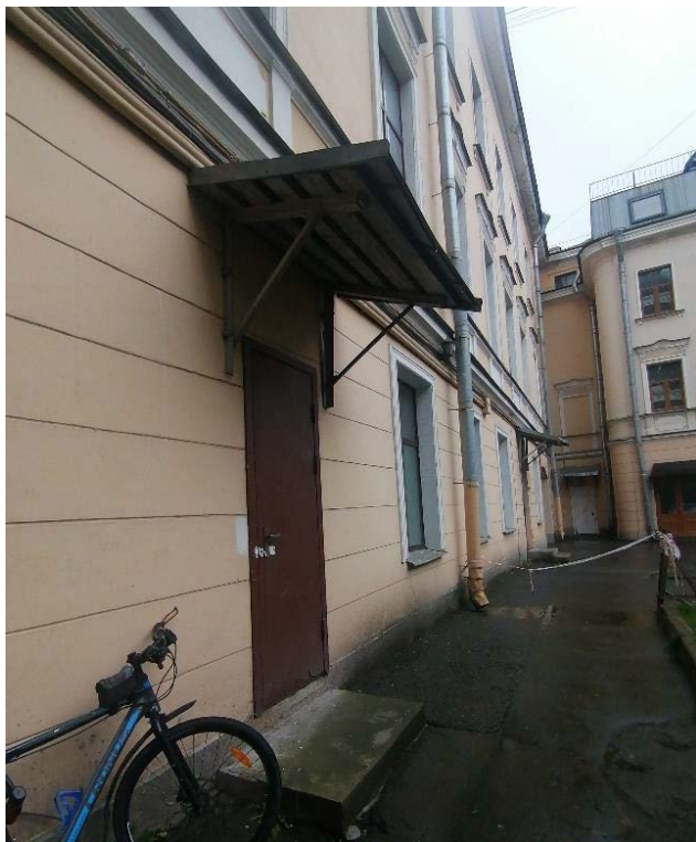
Фото 22. Здание детского отделения городской поликлиники №27. Служебный вход со стороны дворового западного фасада. 12.10.2022г.
