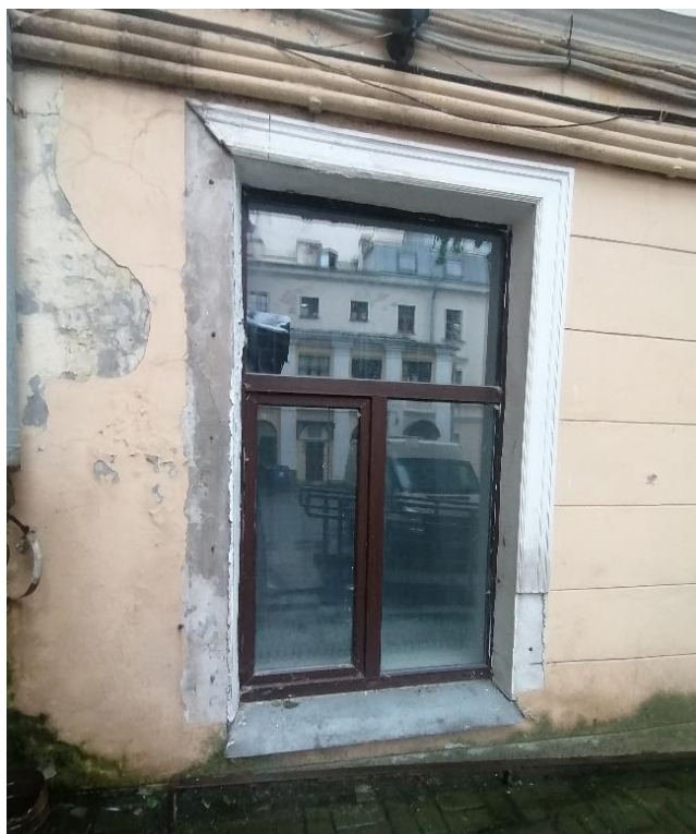
Фото 20. Здание детского отделения городской поликлиники №27. Состояние отделки оконного проема первого этажа западного дворового фасада у пандуса. 12.10.2022г.
