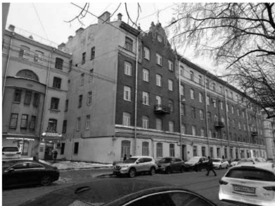
Фото 1 Лицевой фасад выжженного объекта культурного наследия «Дом Б.Е.Фурмана», по адресу: Санкт-Петербург, ул. Смольчкова, д. 15-17, лит. А
