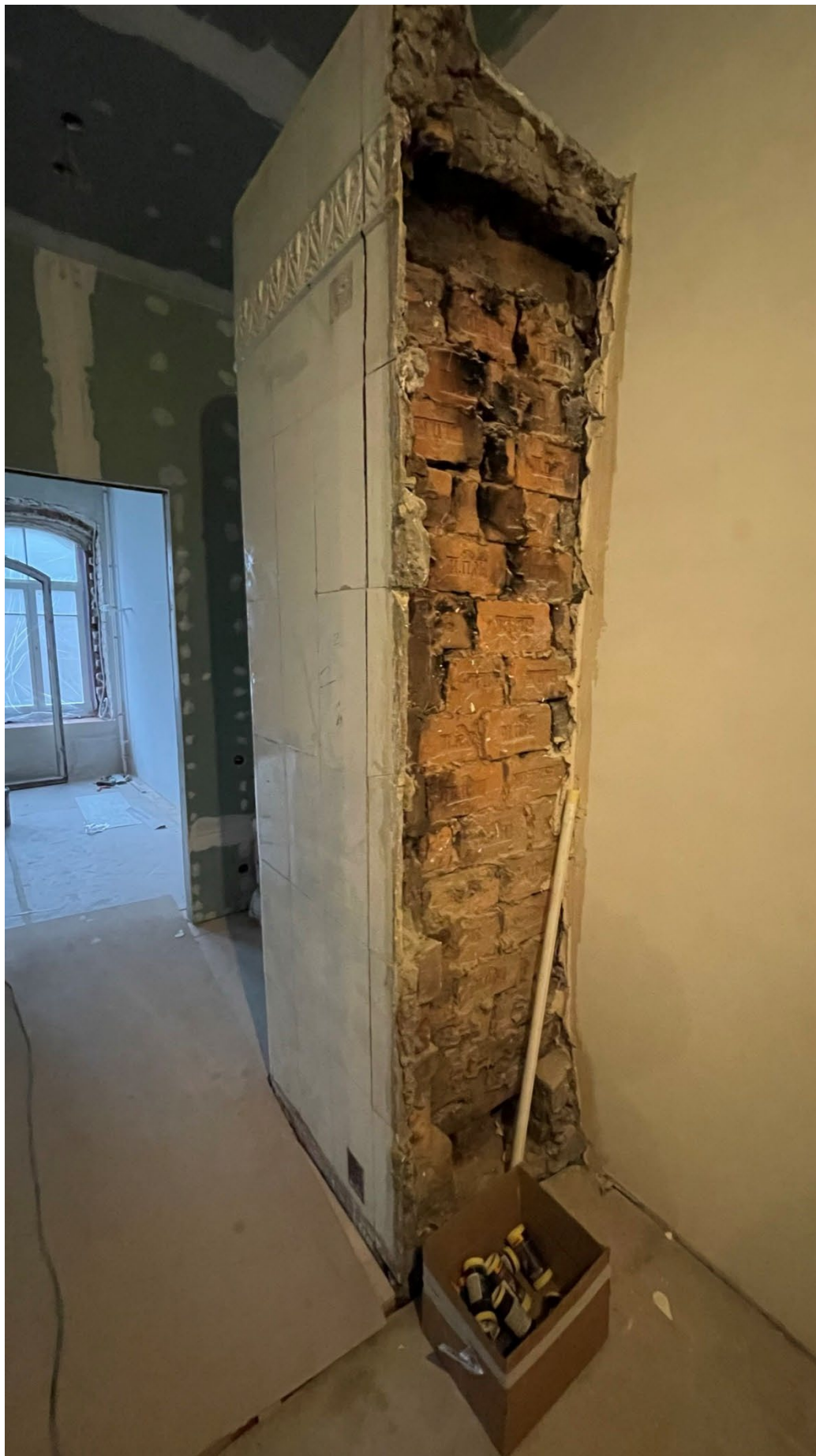
5. Вид на печь (помещение №10);
