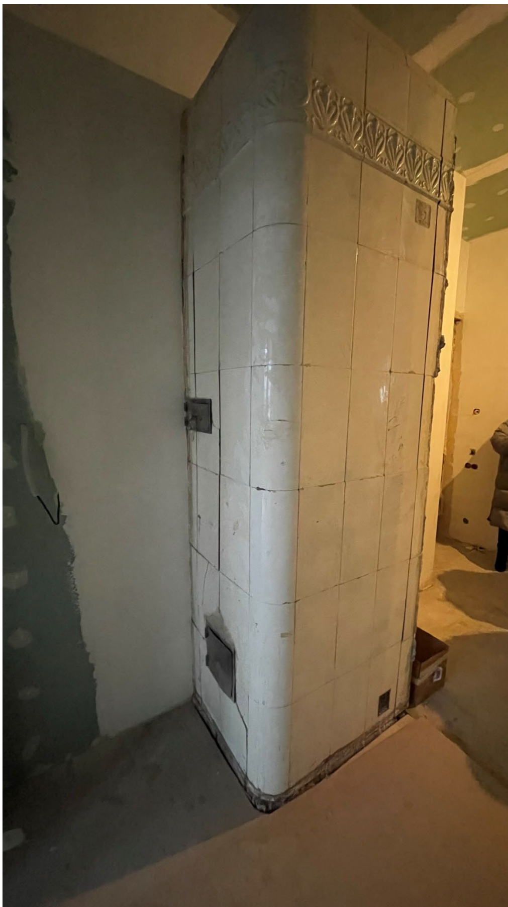
8. Вид на печь (помещение №10);
