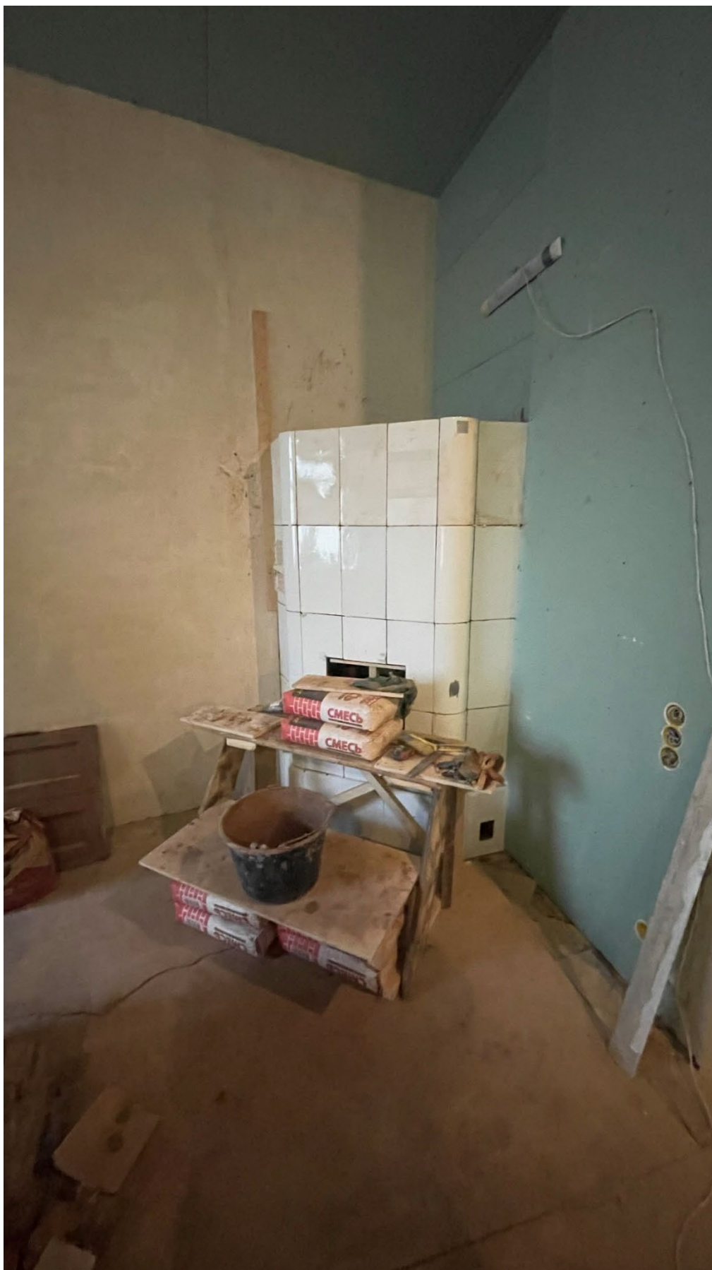
15. Вид на печь (помещение №4);
