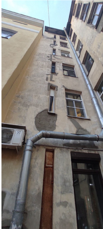
Фото 21. Фасад 10-9. Фасад А-Е. Загрязнение штукатурного слоя, утраты штукатурного слоя до кирпичного основания, отслоение красочного слоя. Поздние цементные вставки, коррозия водоотливов, утрата геометрии, трещины. Утрата штукатурного слоя до кирпичного основания.
