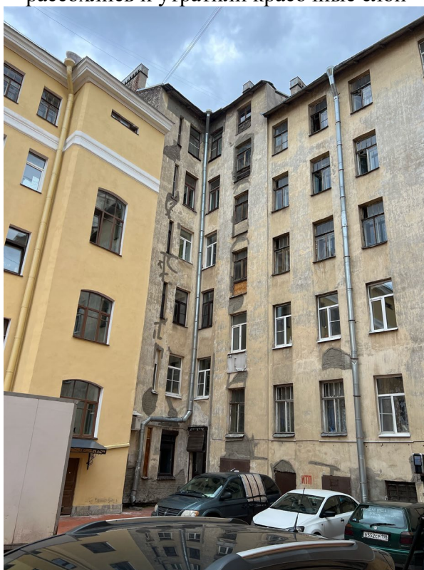
Фото 20. Фасад А-Е. Загрязнение штукатурного слоя, утраты штукатурного слоя до кирпичного основания, отслоение красочного слоя. Поздние цементные вставки, коррозия водоотливов, утрата геометрии, трещины. Утрата штукатурного слоя до кирпичного основания. Деревянные окна лестничной клетки разошлись и утратили красочные слои
