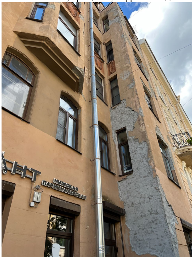
Фото 10. Фасад Б-А по оси 9. Многочисленные цементные вставки, отслоения красочного слоя, трещины
