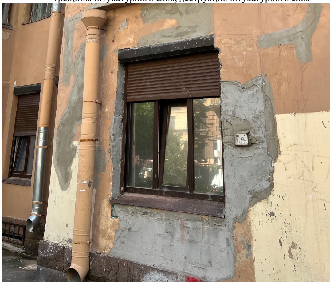
Фото 4. Фасад 1-10. Поздние цементные вставки. Следы многочисленных красочных слоев, загрязнение гранитного цоколя лакокрасочными материалами
