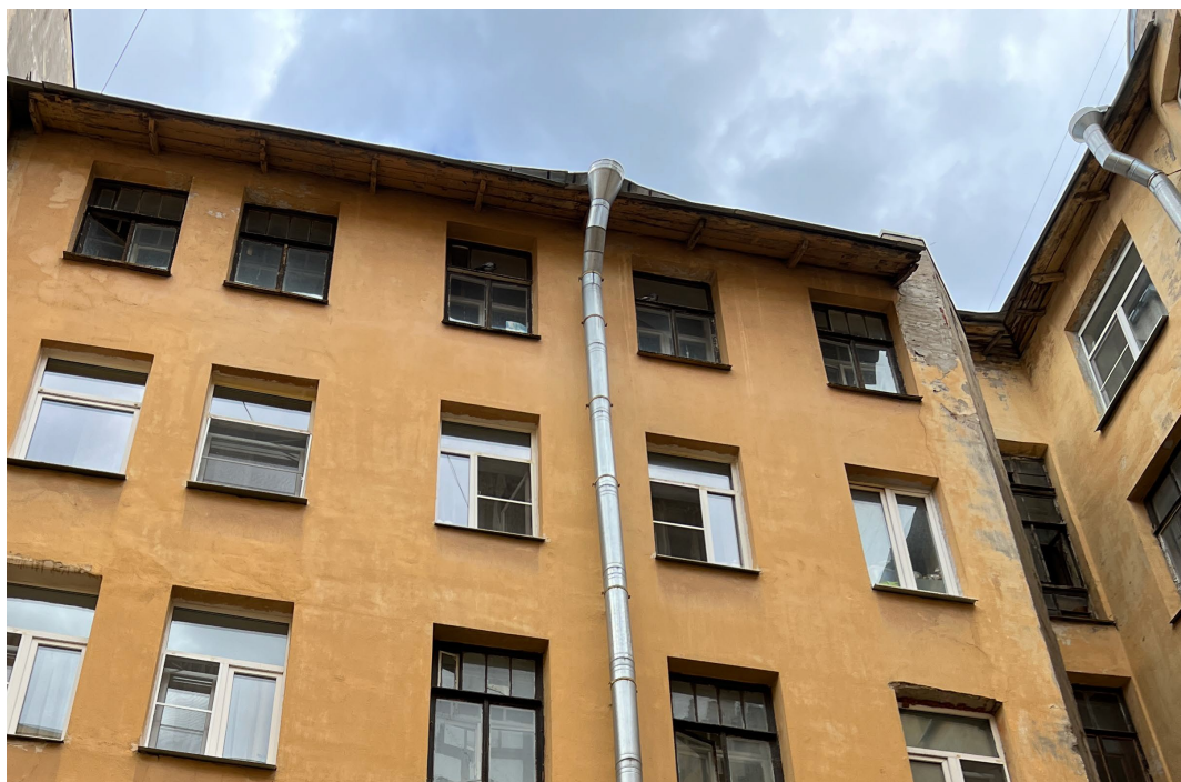
Фото 13. Фасад Е-Д. Шелушение, отслоение красочного слоя, загрязнение фасада, трещины. Кобылки карнизного свеса и подшивка из доски требуют замены
