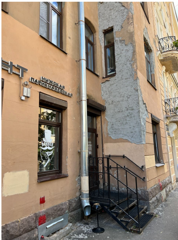
Фото 11. Фасад Б-А по оси 9. Многочисленные цементные вставки, отслоения красочного слоя, трещины, загрязнения гранитного цоколя.
