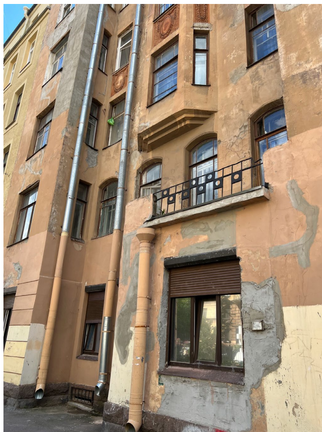
Фото 3. Фасад А-Б по оси 2. Поздние цементные вставки, трещины штукатурного слоя, деструкция штукатурного слоя
