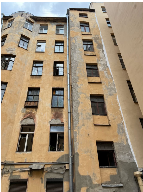
Фото 19. Загрязнение штукатурного слоя, утраты, отслоение красочного слоя. Поздние цементные вставки, коррозия водоотливов, утрата геометрии, трещины. Утрата штукатурного слоя до кирпичного основания. Деревянные окна лестничной клетки разошлись и утратили красочные слои
