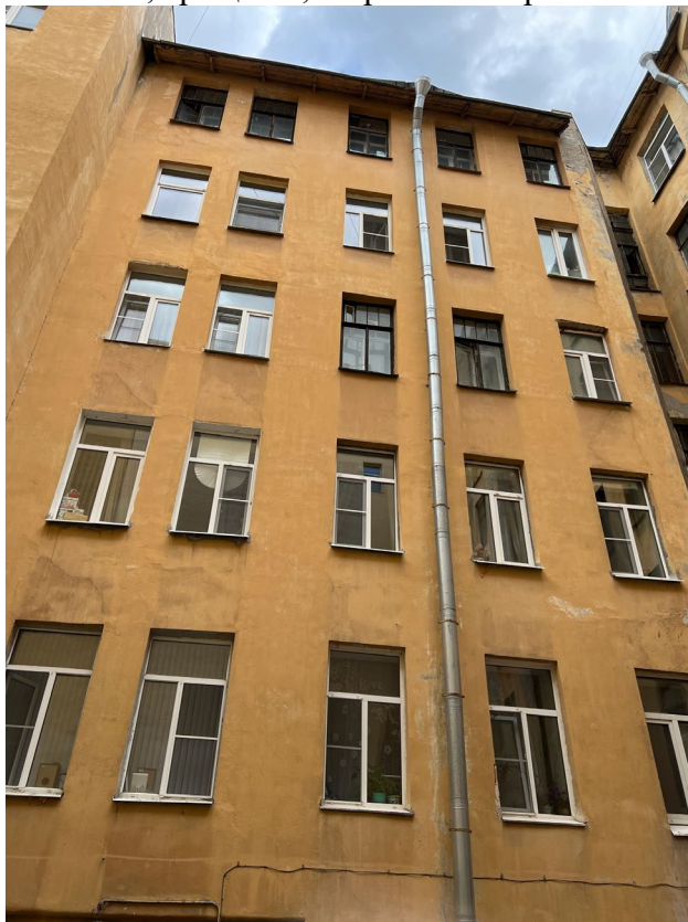
Фото 12. Фасад Е-Д. Шелушение, отслоение красочного слоя, загрязнение фасада, трещины
