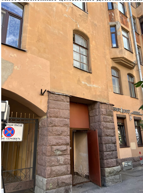
Фото № 8. Фасад 1-10. Портал главного входа: фланкирующие пилоны, выполнены из гранита в технике «рваного камня» с разделкой под руст. Загрязнение гранита лакокрасочными материалами, мелкие сколы, утраты шовного раствора, коррозия водоотливов.
