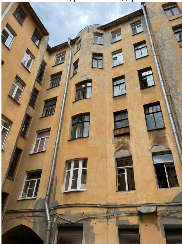
Фото 16. Фасад 7-1. Загрязнение штукатурного слоя, утраты. Поздние цементные вставки, шелушение, отслоение красочного слоя
