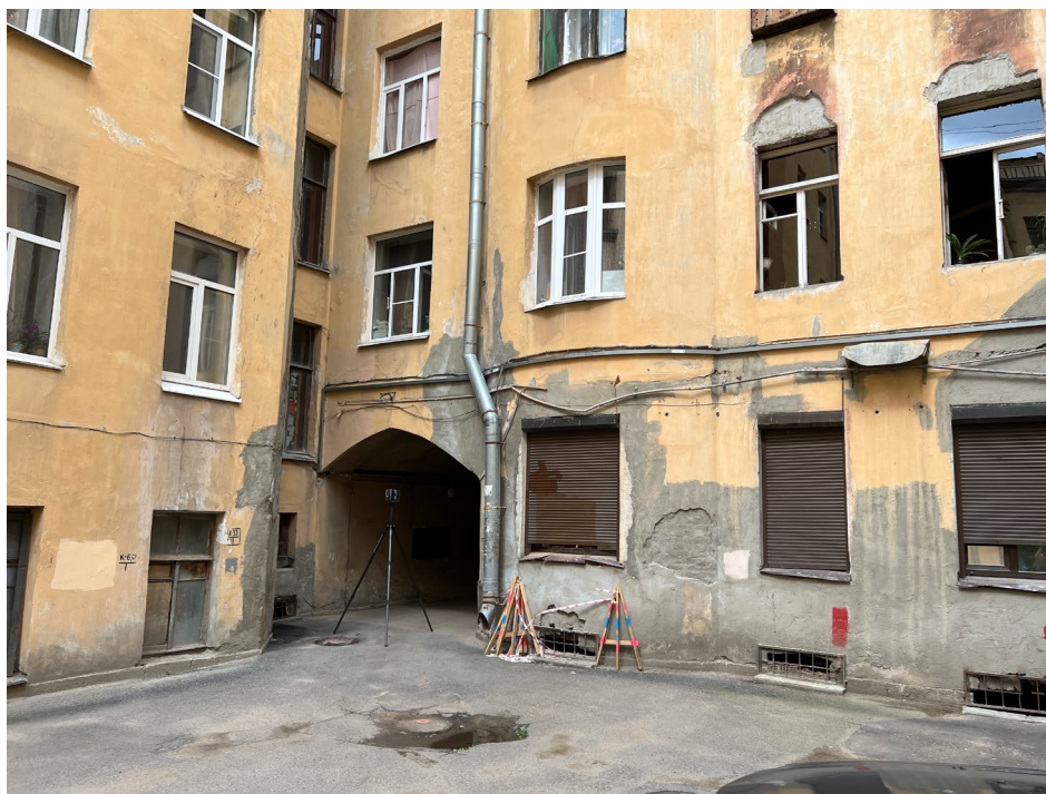
Фото 17. Загрязнение штукатурного слоя, утраты, отслоение красочного слоя. Поздние цементные вставки, коррозия водоотлива, утрата геометрии, трещины. Утрата штукатурного слоя до кирпичного основания, коррозия металлической решетки, утрата окон подвала.
