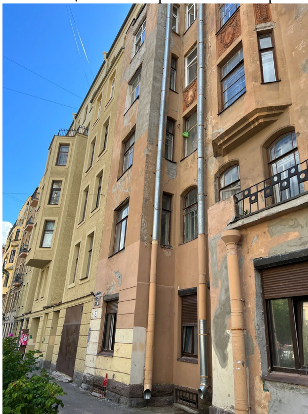
Фото 6. Фасад А-Б по оси 2. Загрязнение, деструкция штукатурного слоя, трещины в штукатурном слое шелушение красочного слоя, гранитного цоколя, высолы в районе эркера, многочисленные цементные вставки.
