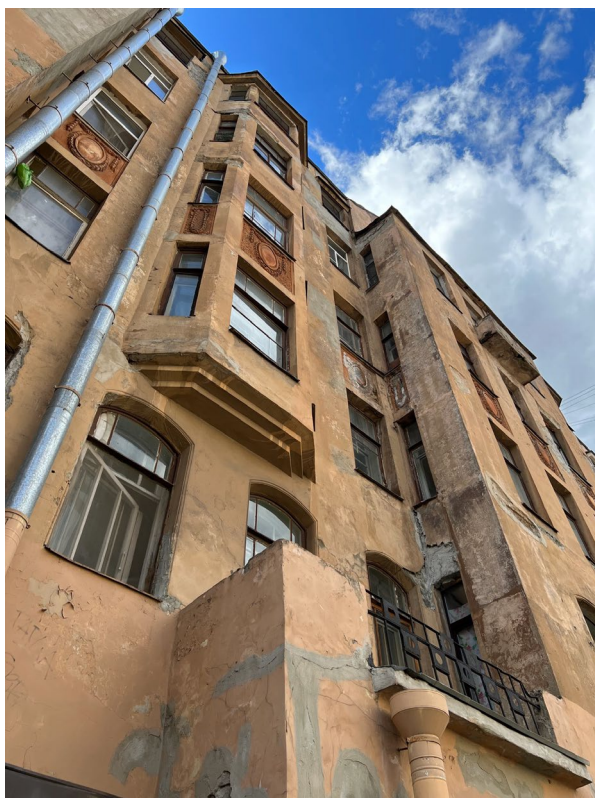
Фото 7. Фасад 1-10, Торцевой фасад Б-А по оси 3. Загрязнение, деструкция штукатурного слоя отслоение, шелушение красочного слоя, сколы, утраты лепного декора, трещины в штукатурном слое, утраты штукатурного слоя до кирпичной кладки, многочисленные цементные докомпоновки
