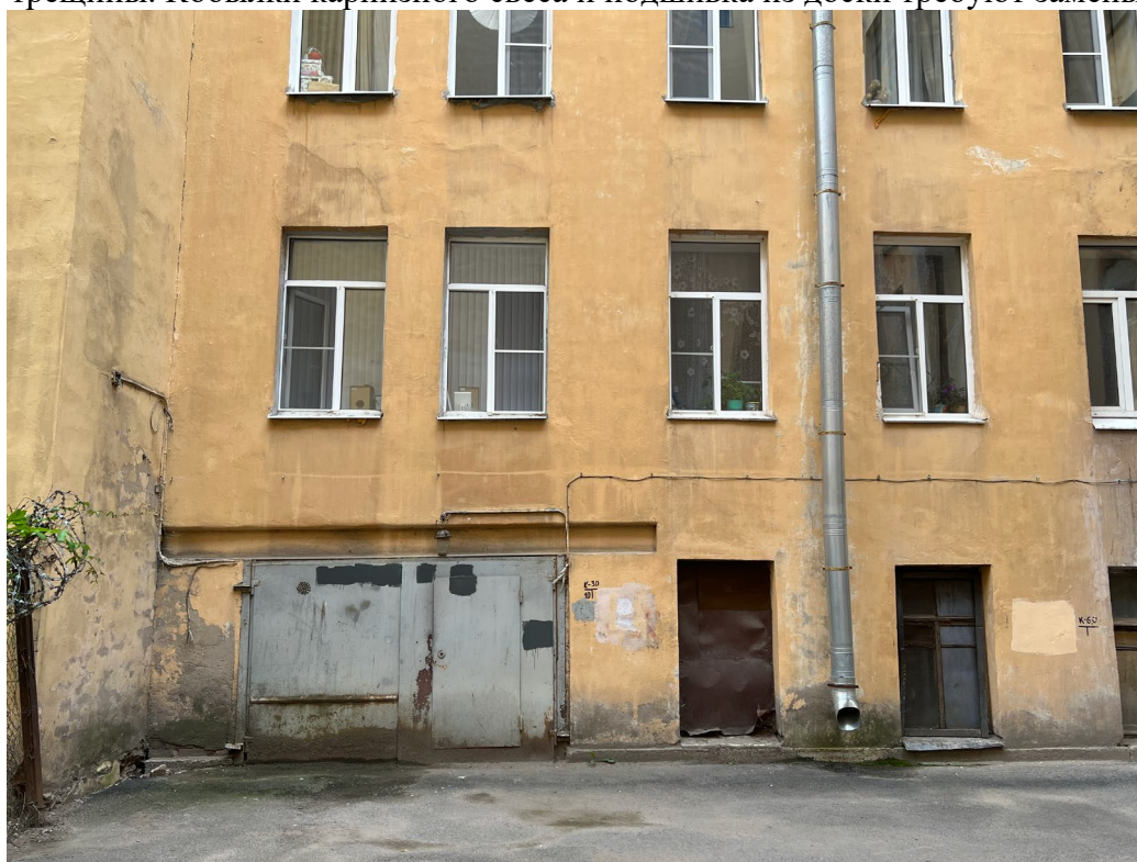
Фото 14. Фасад Е-Д. Шелушение, отслоение красочного слоя, загрязнение фасада, трещины. Окно первого этажа зашито металлическим листом. Ворота В- 4 коррозированы, поздние цементные вставки, биопоражения штукатурного слоя и известнякового цоколя
