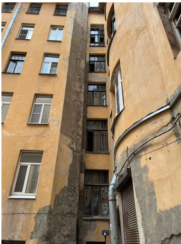
Фото 15. 1-8. Фасад Е-Д. Шелушение, отслоение красочного слоя, загрязнение фасада, трещины, поздние цементные вставки, рассыхание деревянных окон лестничной клетки
