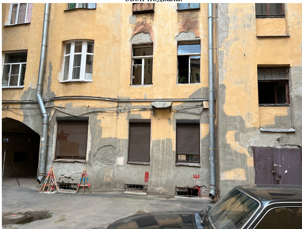
Фото 18. Загрязнение штукатурного слоя, утраты, отслоение красочного слоя. Поздние цементные вставки, коррозия водоотлива, утрата геометрии, трещины. Утрата штукатурного слоя до кирпичного основания, коррозия металлической решетки, утрата окон подвала
