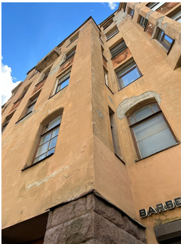
Фото 9. Фасад А-Б по оси 8. Шелушение, отслоение красочного слоя, поздние цементные вставки, трещины, коррозия водоотливов
