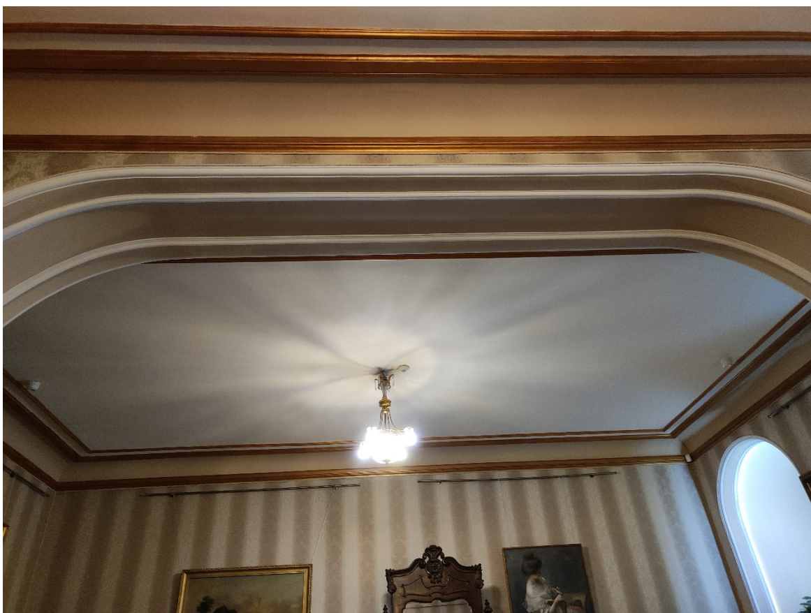
13. Вид западной стены пом. № 12 на 1-м этаже лицевого корпуса по Английской наб.
