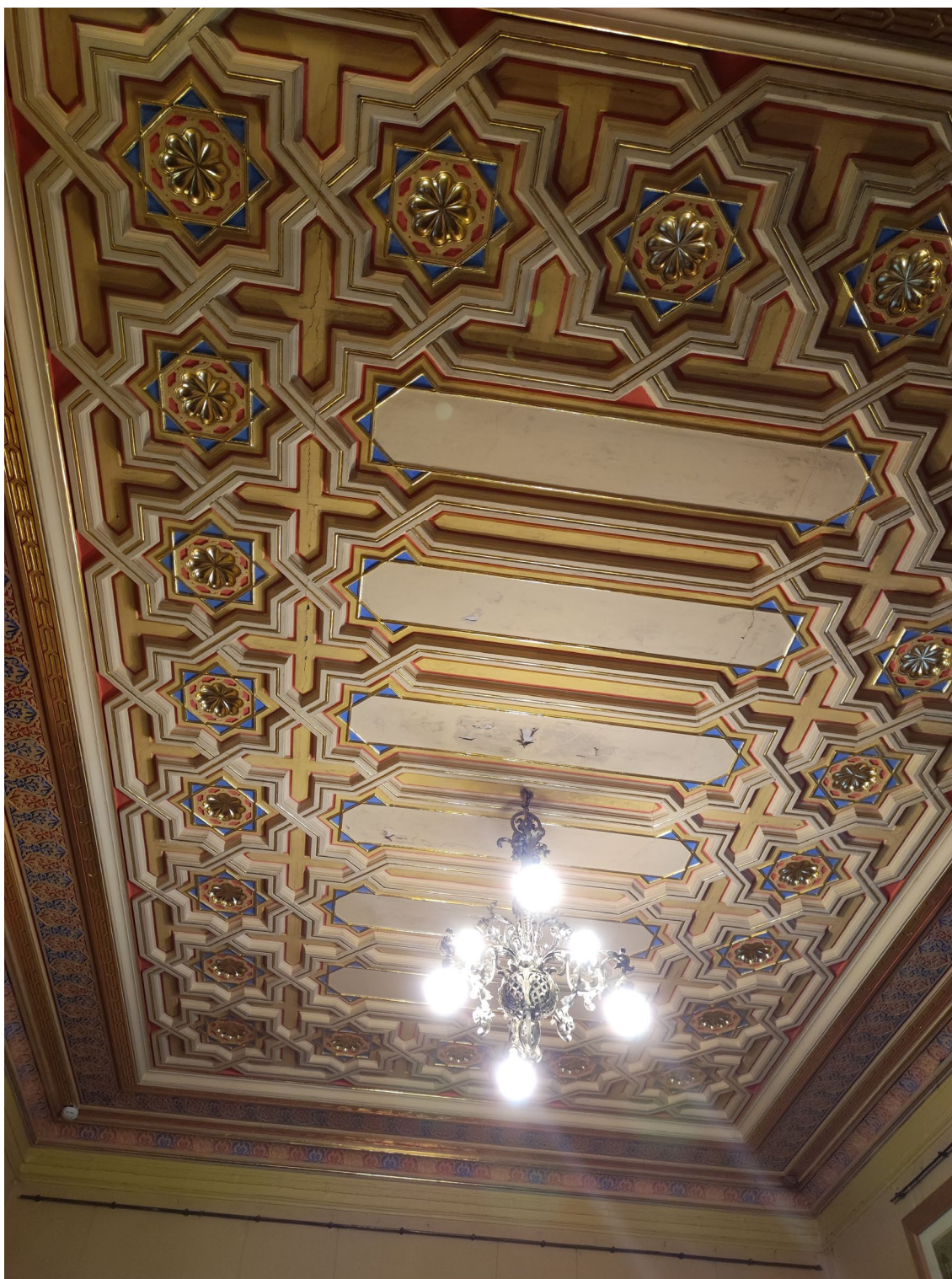
17. Вид потолка в пом. № 19 на 1-м этаже лицевого корпуса по Английской наб. Направление съемки восток (Нева слева).
