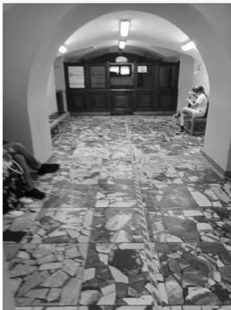
2. Объект культурного наследия федерального значения «Кунсткамера», по адресу: Санкт-Петербург, Университетская набережная, дом № 3, литера Б (Университетская наб., 3). Подвал. Дата съемки: 12.08.2022г.
