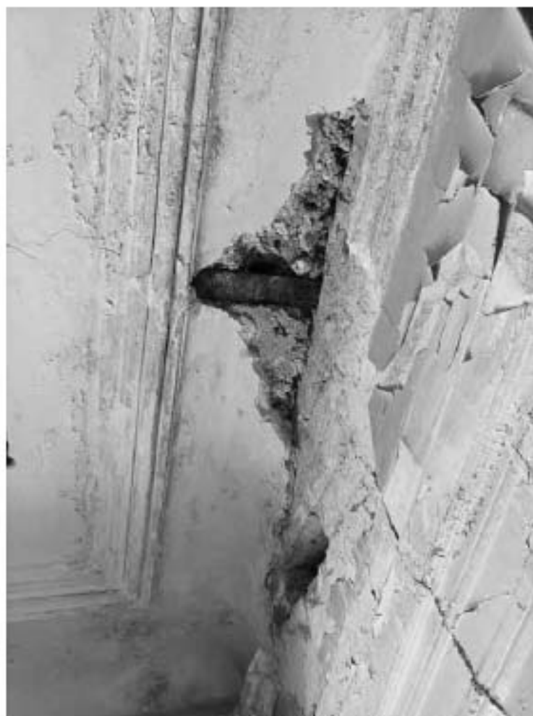
22. Объект культурного наследия федерального значения «Кунсткамера», по адресу: Санкт-Петербург, Университетская набережная, дом № 3, литера Б (Университетская наб., 3). Фрагмент перекрытия лестничной клетки. Дата съемки: 12.08.2022г.
