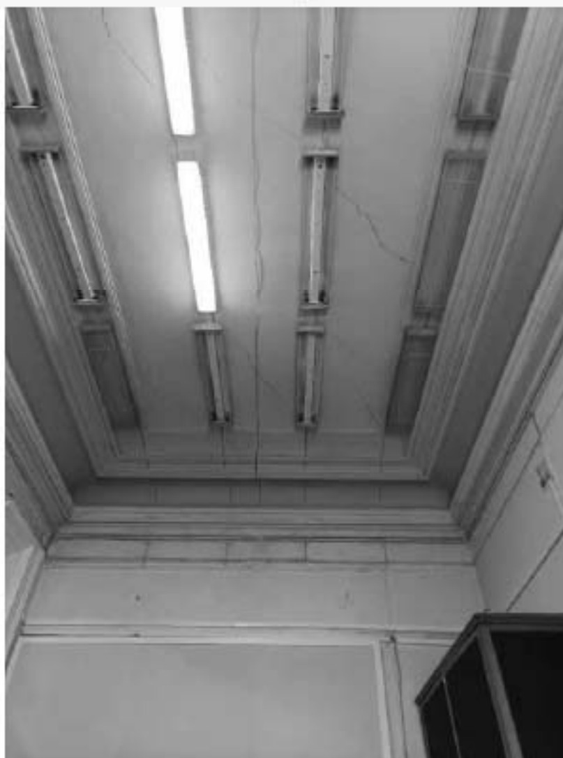
48. Объект культурного наследия федерального значения «Кунсткамера», по адресу: Санкт-Петербург, Университетская набережная, дом № 3, литера Б (Университетская наб., 3). Потолок экспозиционного зала 2 этажа. Дата съемки: 12.08.2022г.
