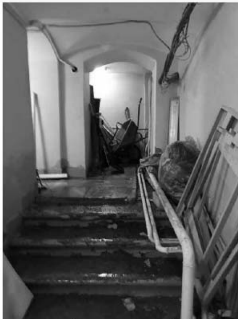
6. Объект культурного наследия федерального значения «Кунсткамера», по адресу: Санкт-Петербург, Университетская набережная, дом № 3, литера Б (Университетская наб., 3). Подвал. Дата съемки: 12.08.2022г.
