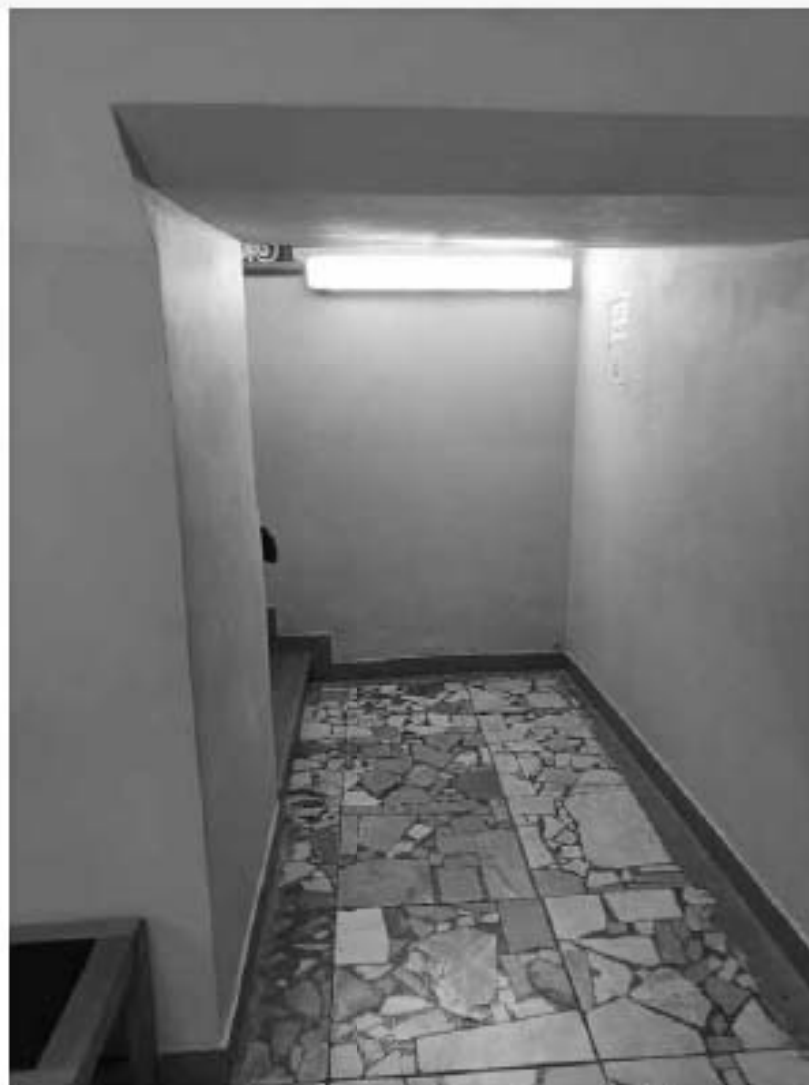
10. Объект культурного наследия федерального значения «Кунсткамера», по адресу: Санкт-Петербург, Университетская набережная, дом № 3, литера Б (Университетская наб., 3). Подвал. Дата съемки: 12.08.2022г.
