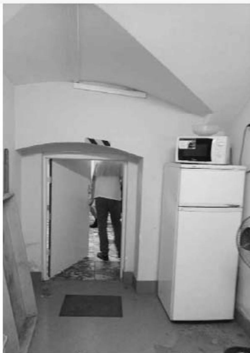
3. Объект культурного наследия федерального значения «Кунсткамера», по адресу: Санкт-Петербург, Университетская набережная, дом № 3, литера Б (Университетская наб., 3). Подвал. Дата съемки: 12.08.2022г.
