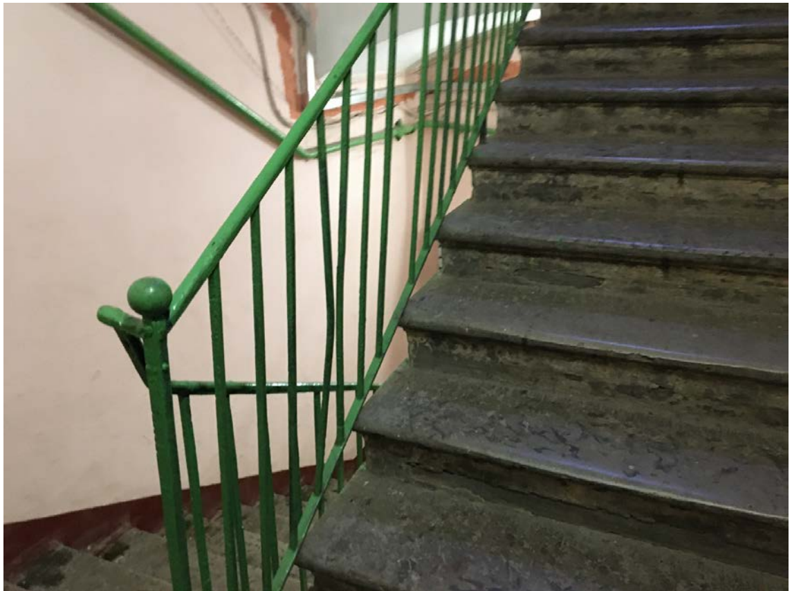
31. Лестница Л-3. Ограждение.
