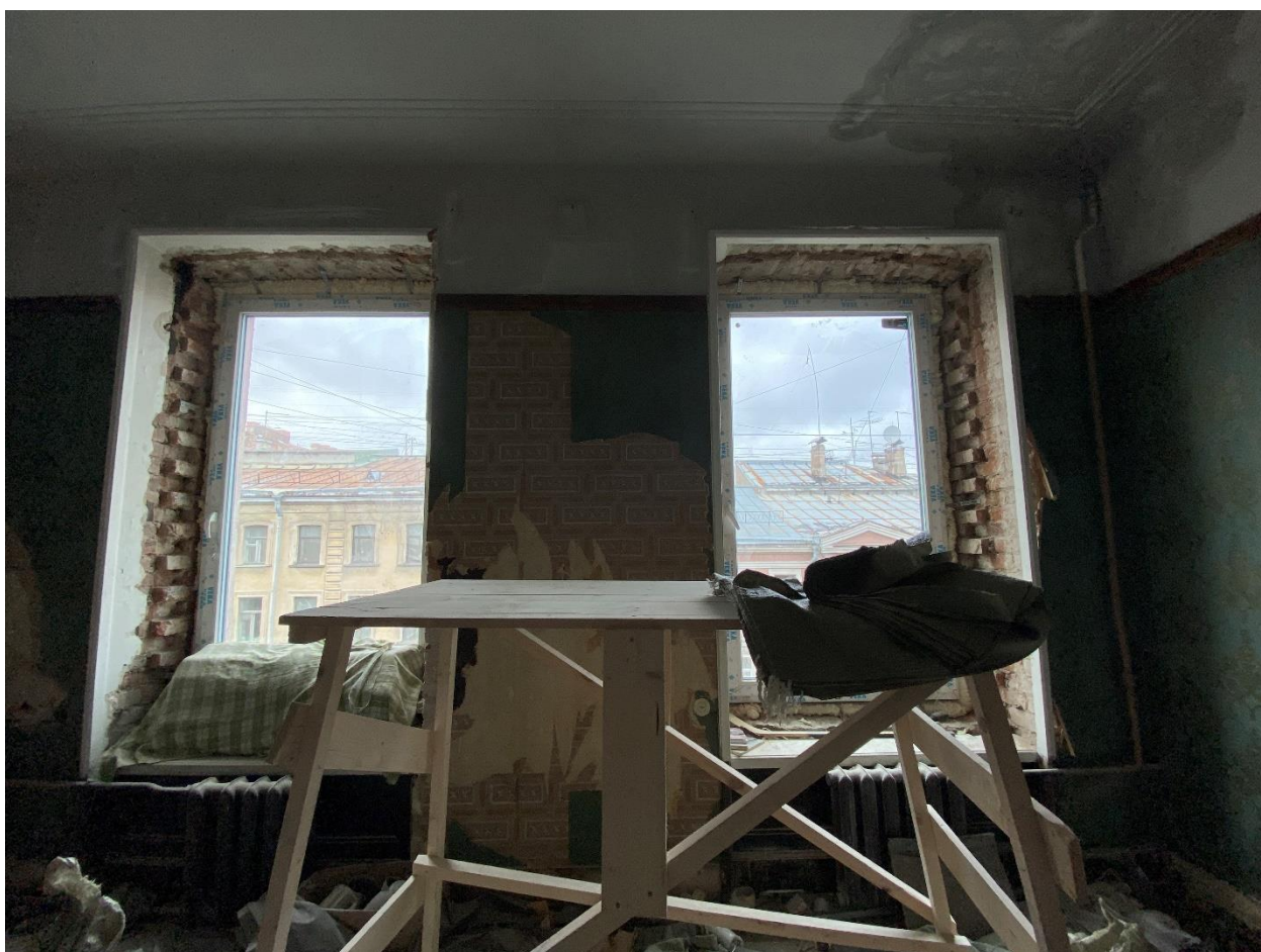
Фото 22. Помещение № 10. Комната. Современные металлопластиковые оконные заполнения с сохранением исторического рисунка расстекловки в помещении № 11. Вид с востока.
