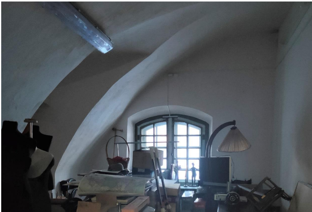
38. Объект культурного наследия федерального значения «Бастион Нарышкин» в составе объекта культурного наследия федерального значения «Петропавловская крепость» по адресу: г. Санкт-Петербург, Петропавловская крепость, дом 3, литера Д (о. Заячий, Петропавловская крепость). Каземат №8. Службное помещение. Общий вид.
