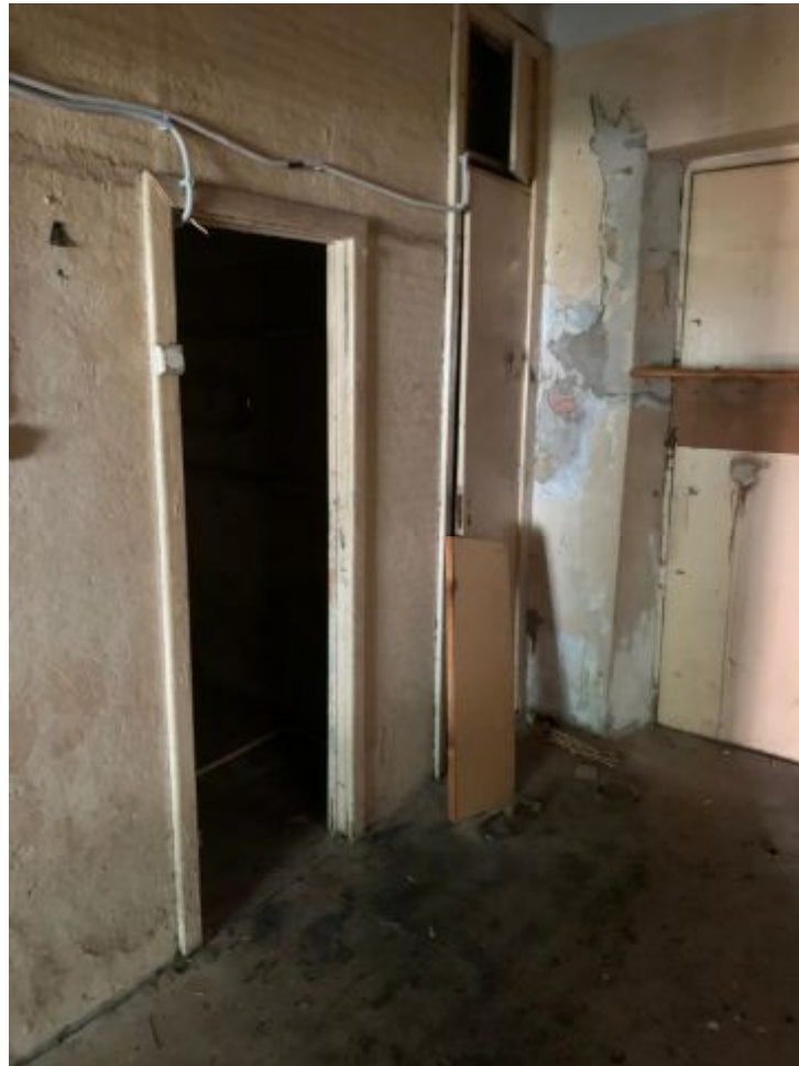
14. ОКН федерального значения «Корпус служебный казарм Первого учебного морского экипажа» (г. Кронштадт, Коммунистическая ул., д. 3 лит. А). Помещение 4-Н.
