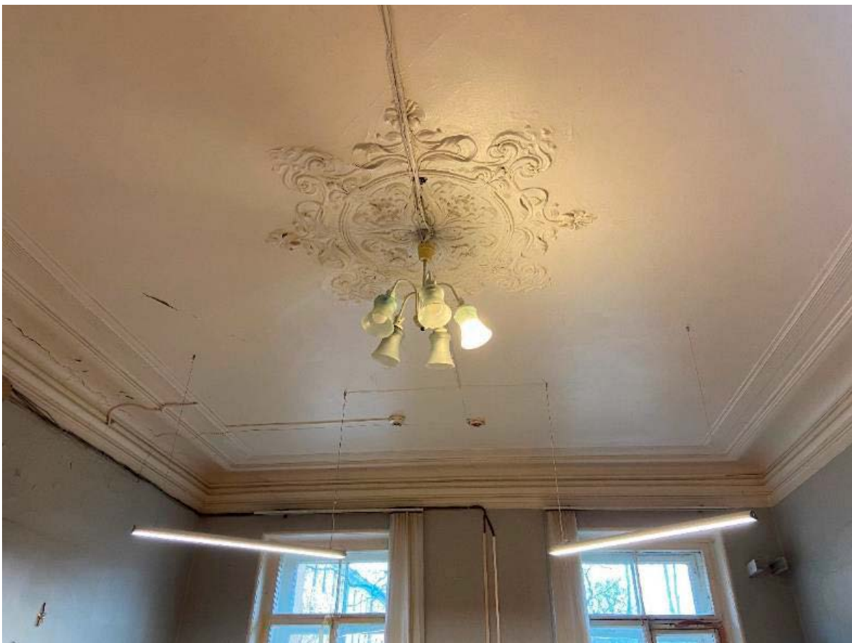
32. Пом. №37 (1-Н) в уровне 2-го этажа объекта культурного наследия федерального значения «Лицей Императорский Александровский. Корпус воспитателей. Здесь в Радиевом институте работали: в 1922-1938 гг. – Вернадский В.И., в 1922-1950 гг. – радиохимик Хлопин В.С.», расположенного по адресу: г. Санкт-Петербург, ул. Рентгена, д. 1, литера А. 12.05.2022
