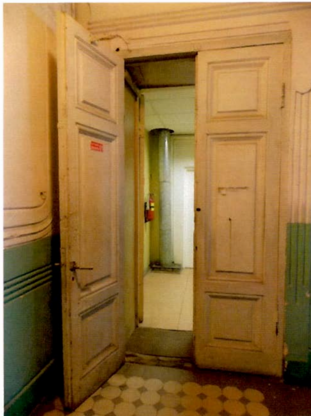
8. Дверь на лестничной площадке 3-го этажа.
