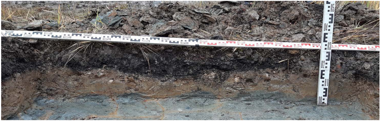
Рис. 36. Санкт-Петербург, «проектирование водопроводных и канализационных сетей для подключения к храму в честь святителя Алексия, митрополита Московского на земельном участке с кадастровым номером 78:13:0007457:20». Шурф 1. Фотофиксация стратиграфии западной стенки.
