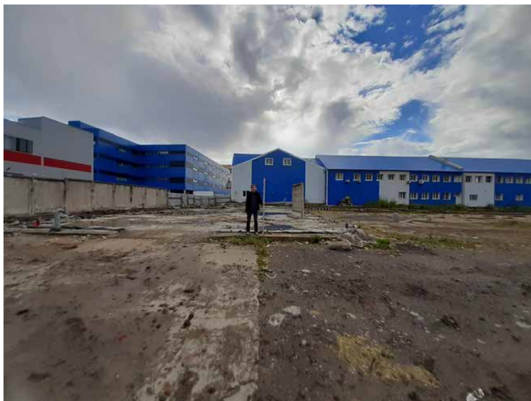
Рис. 10. Санкт-Петербург, Кубинская улица. Земельный участок с кадастровым номером 78:14:0007558:8107. Общий вид участка обследования. Точка съемки 1. Вид на юго-запад
