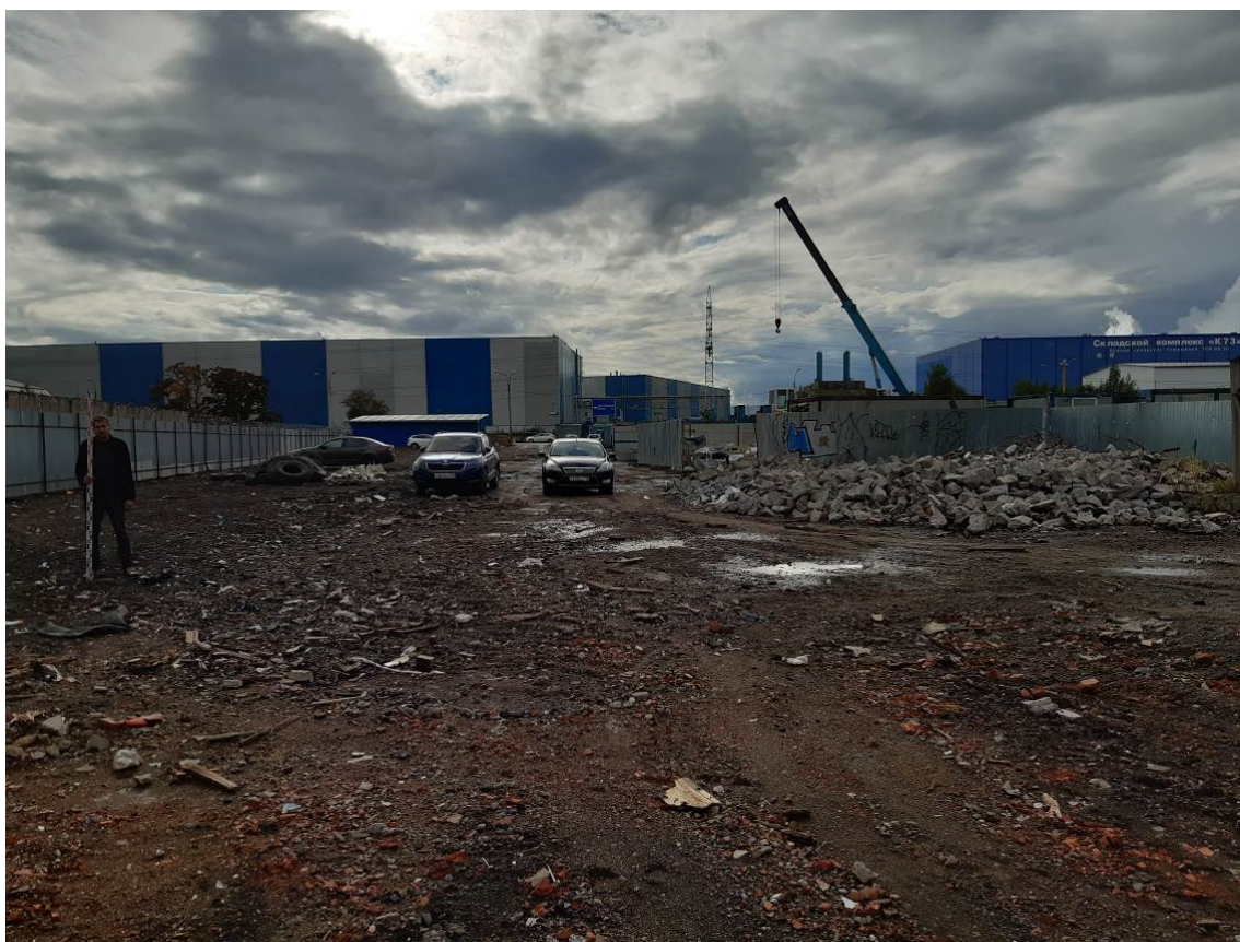
Рис. 16. Санкт-Петербург, Кубинская улица. Земельный участок с кадастровым номером 78:14:0007558:8108. Общий вид участка обследования. Точка съемки 7. Вид на юго-запад
