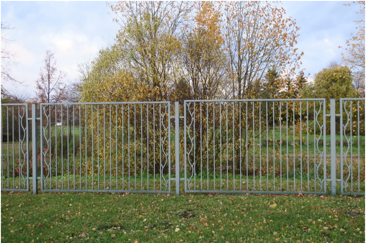
17. Северная часть ограды объекта культурного наследия федерального значения «Кладбище Пискаревское», расположенного по адресу: г. Санкт-Петербург, пр. Непокоренных, д. 72 литера А. 15.10.2021
