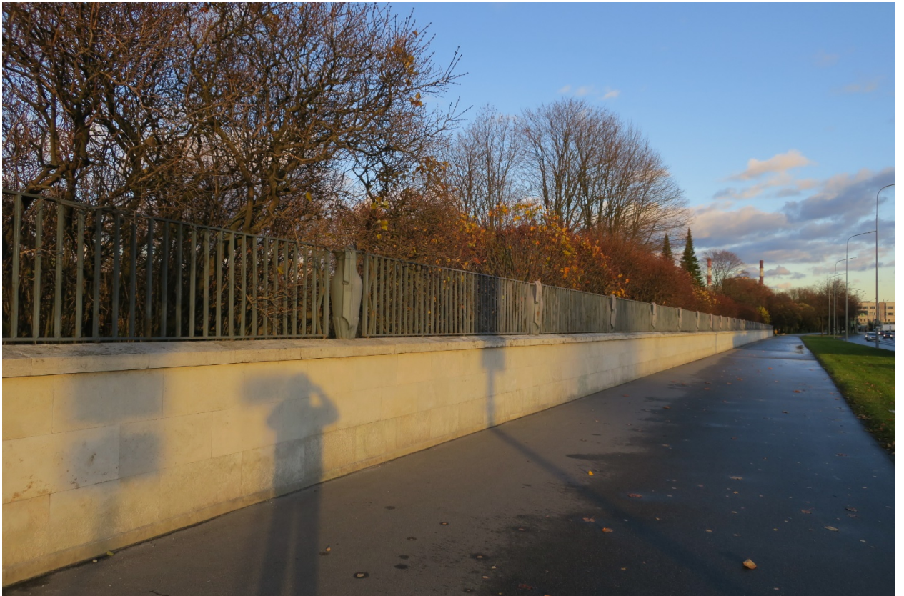
2. Южная часть ограды объекта культурного наследия федерального значения «Кладбище Пискаревское», расположенного по адресу: г. Санкт-Петербург, пр. Непокоренных, д. 72 литера А. Восточная сторона. 15.10.2021
