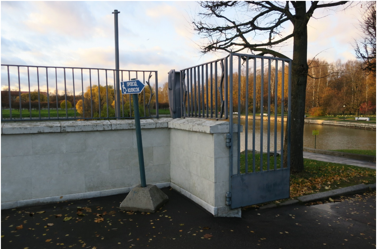
7. Южная часть ограды объекта культурного наследия федерального значения «Кладбище Пискаревское», расположенного по адресу: г. Санкт-Петербург, пр. Непокоренных, д. 72 литера А. Западная сторона. 15.10.2021
