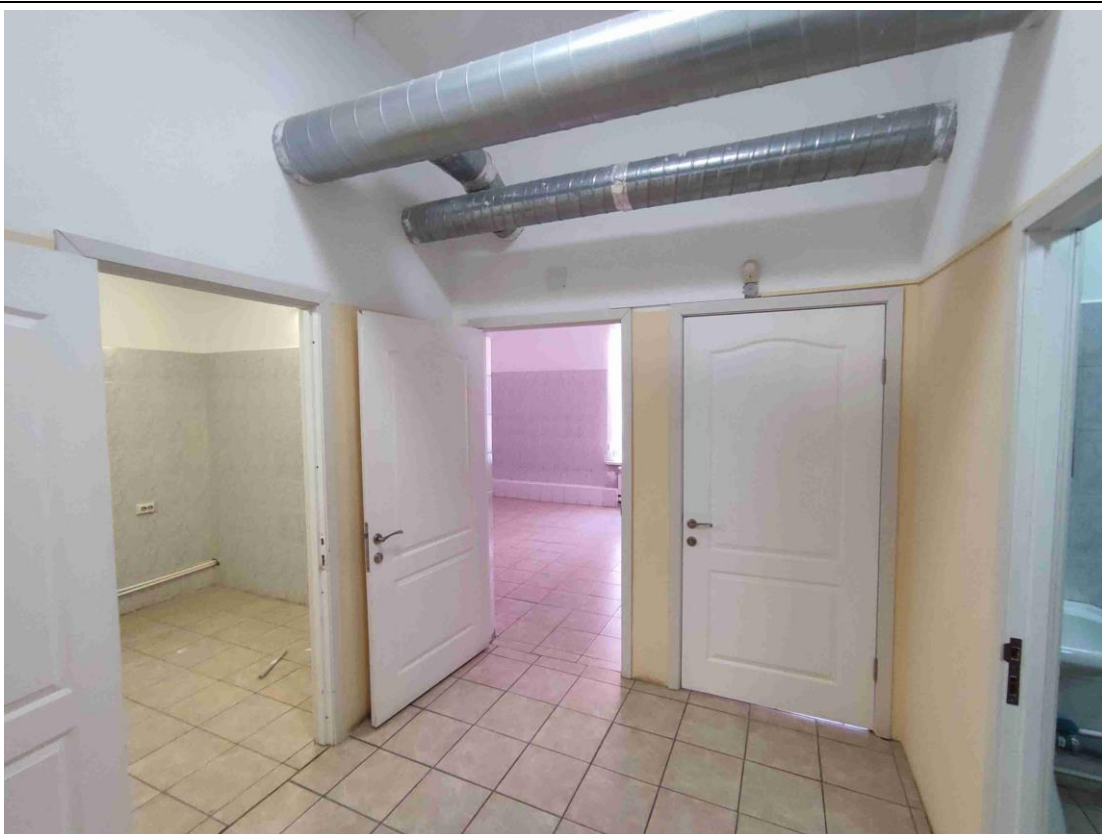
11. Общий вид пом. 6-Н (40) в уровне 1-го этажа. Проектными решениями предполагается объединение данного помещения с пом. 6-Н (41) для размещения регистратуры кабинета компьютерной томографии.
