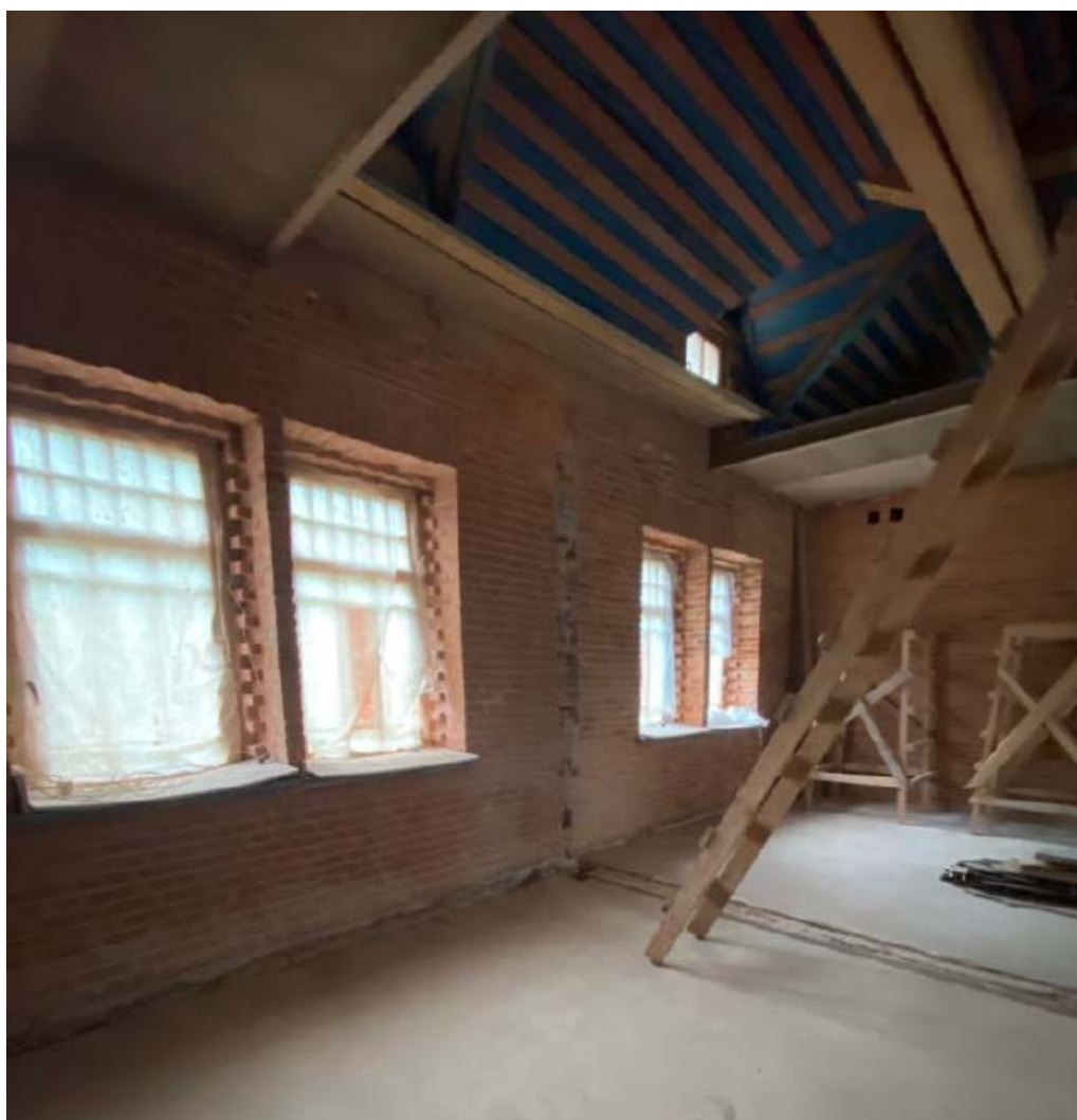
11. Помещение №1 (2-Н и 3-Н) объекта культурного наследия регионального значения «Службы при дворце О.В. Гогенфельзен (Палей)», расположенного по адресу: Санкт-Петербург, г. Пушкин, Московский пер. д. 7/20, литера А. Проем в чердачном перекрытии. 04.11.2022.
