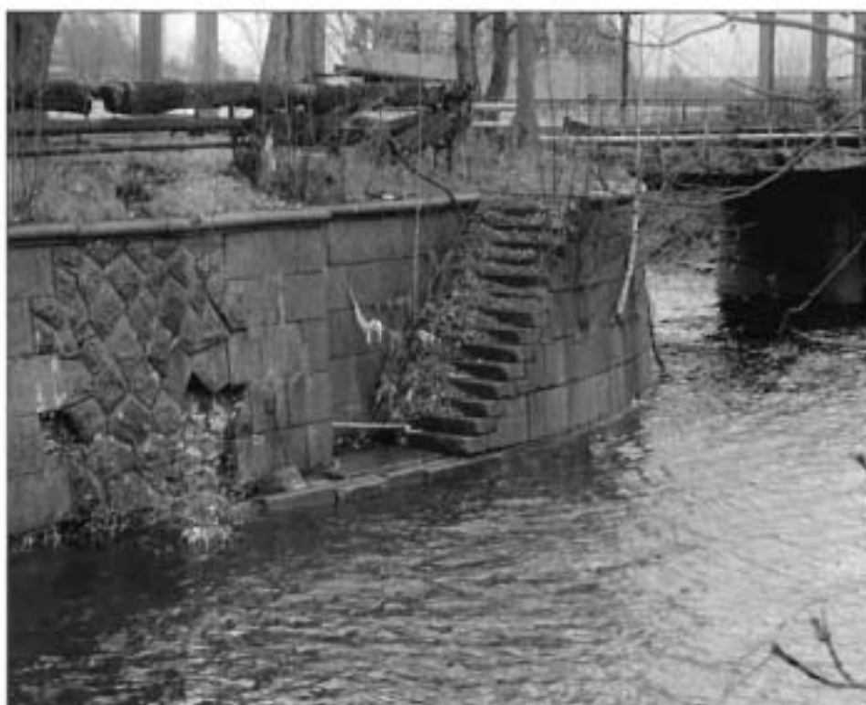
4. Спуск к воде (у соединения с выводным каналом им. Петра Великого в юго-восточной части 2 шт.) в виде исторических лестниц с гранитными ступенями.
