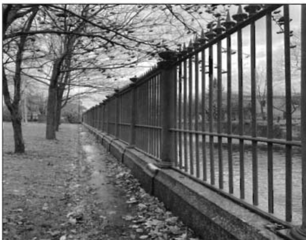
14. Ограда вдоль ул. Советской. Наверху столбов ограды в виде стилизованных изображениями урн; вертикальные стойки ограды в завершении оформлены стилизованными пиками.
