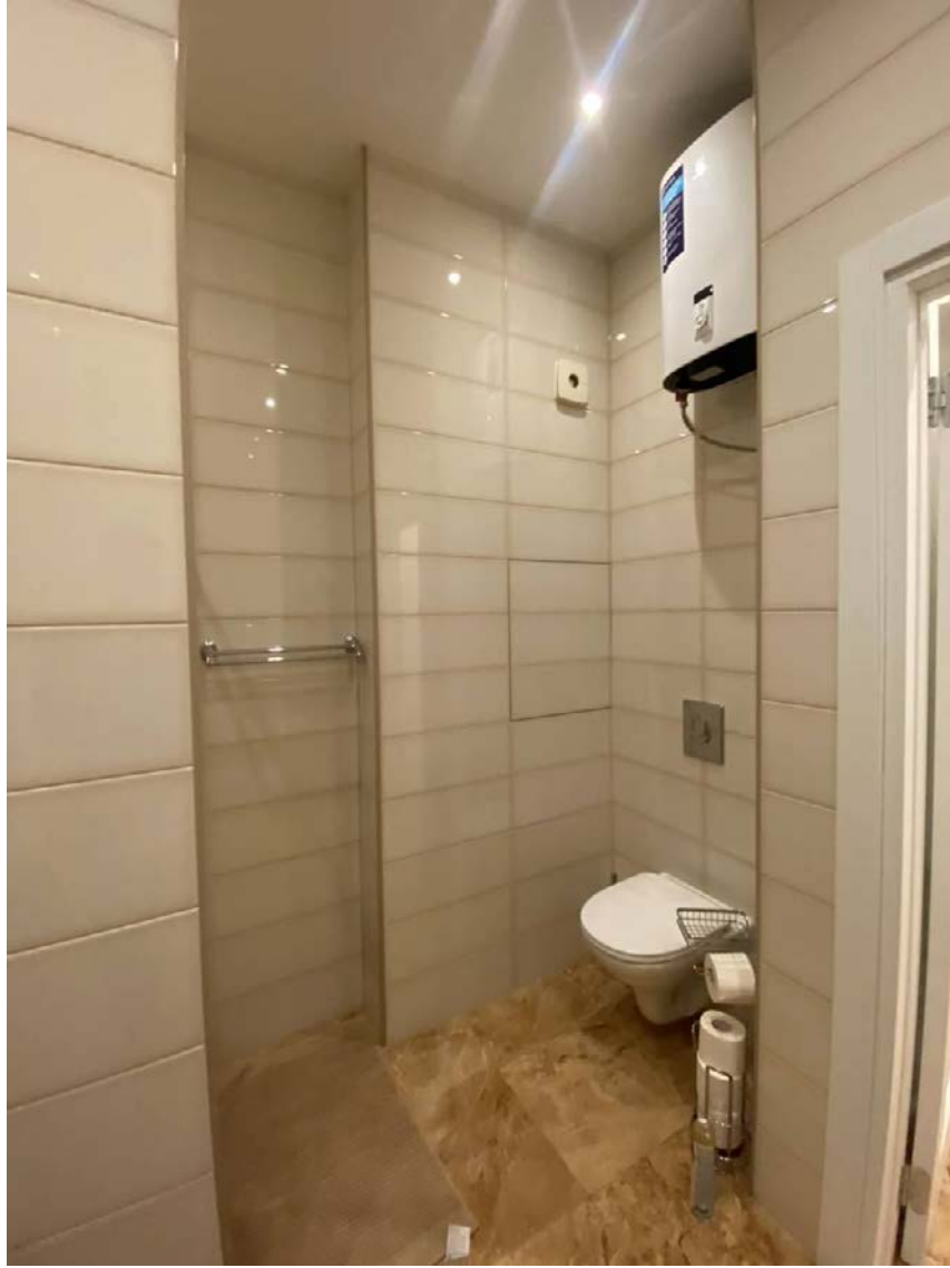
8. Вид в совмещенном санузле квартиры № 51 (пом.2).
