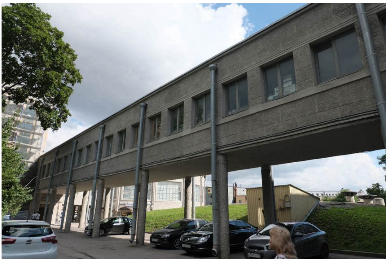
7. Переходная галерея северо-западного фасада объекта культурного наследия федерального значения «Райсовет Кировский», расположенного по адресу: г. Санкт-Петербург, пр. Стачек, д. 18, литера А. 09.11.2022.
