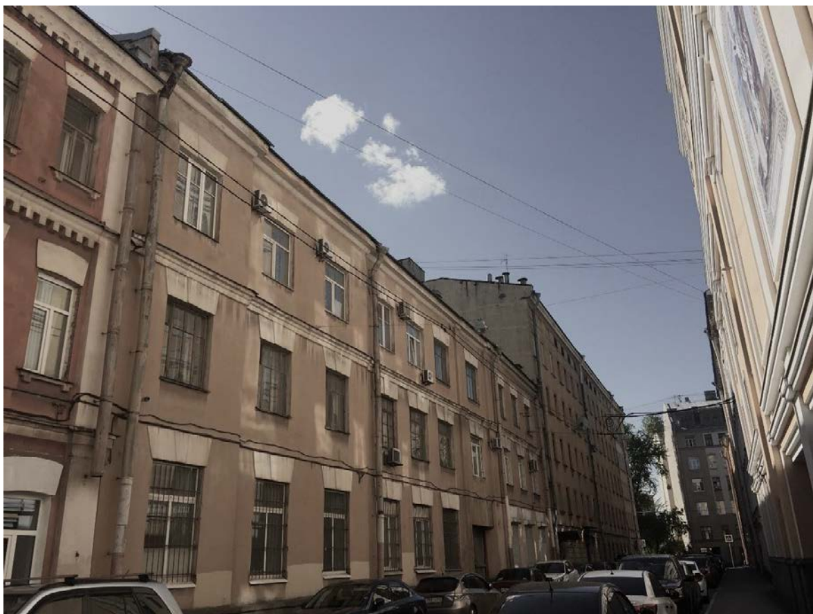
Фото 21. Вид со стороны переулка Лодыгина на Объект по адресу: Рижский пр, д.26, лит. Б (подлитеры Б8, Б6, Б4).
