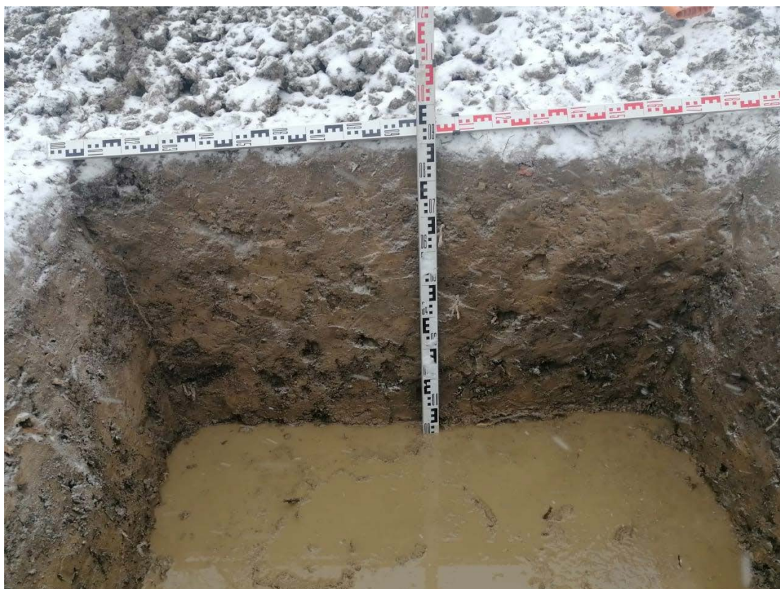
Рис. 24. СПб 2022, Пушкинский район «Реконструкция тепловых сетей отопления и ГВС от групповой котельной в пос. Шушары, Пулковское шоссе, д. 42, лит. А». Шурф 1. Фиксация по уровню грунтовых вод. Северная стенка.
