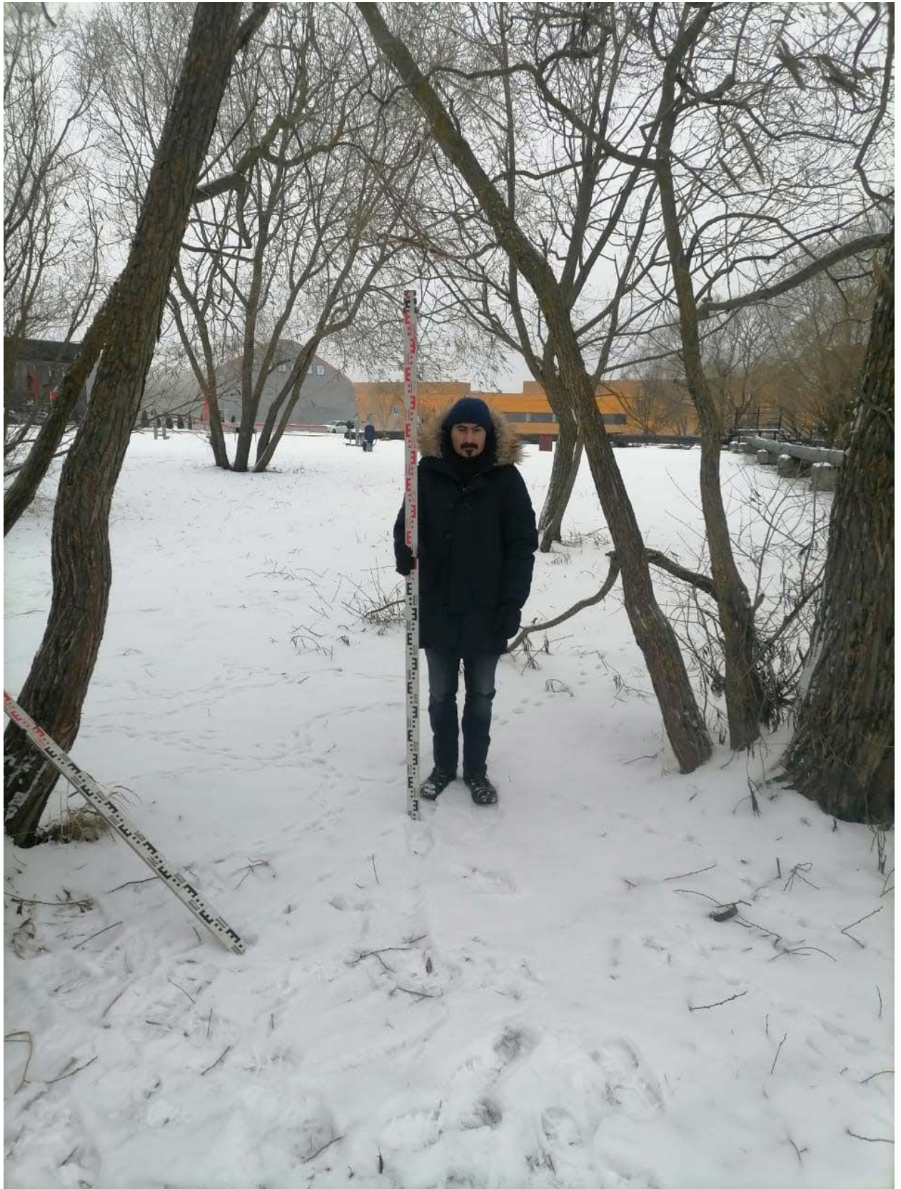
Рис. 7. СПб 2022, Пушкинский район «Реконструкция тепловых сетей отопления и ГВС от групповой котельной в пос. Шушары, Пулковское шоссе, д. 42, лит. А». Точка фотофиксации 1. Вид на запад.
