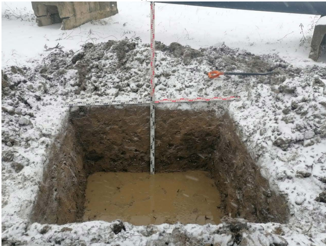
Рис. 23. СПб 2022, Пушкинский район «Реконструкция тепловых сетей отопления и ГВС от групповой котельной в пос. Шушары, Пулковское шоссе, д. 42, лит. А». Шурф 1. Фиксация по уровню грунтовых вод. Вид на север.
