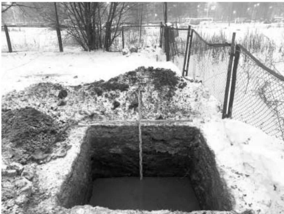
Илл. 52. Санкт-Петербург, Красногвардейский район, Салтыковская дорога, д. 15, лит. А. Шурф 1. Общий вид западной стенки с востока. 27.11.2022 г.
