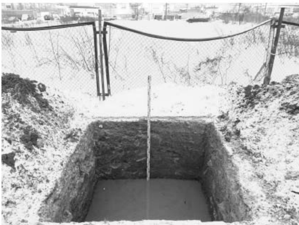
Илл. 46. Санкт-Петербург, Красногвардейский район, Салтыковская дорога, д. 15, лит. А. Шурф 1. Общий вид С стенки с юга. 27.11.2022 г.
