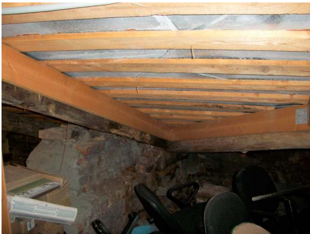
15. Объект культурного наследия регионального значения «Городской дом начальных училищ им. М.Г. Петрова», по адресу: Санкт-Петербург, Малоохтинский проспект, дом 51, литера А. Чердачное помещение. Дата съемки: 19.09.2022г.
