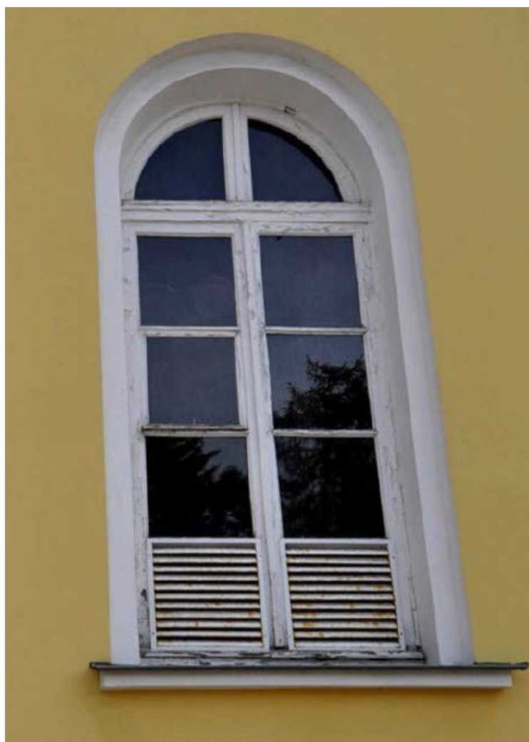
4. Оконное заполнение в уровне 1-ого этажа объекта культурного наследия федерального значения «Дворец Таврический. Дворец», расположенного по адресу: г. Санкт-Петербург, ул. Шпалерная, д. 47, лит. А. 15.12.2022
