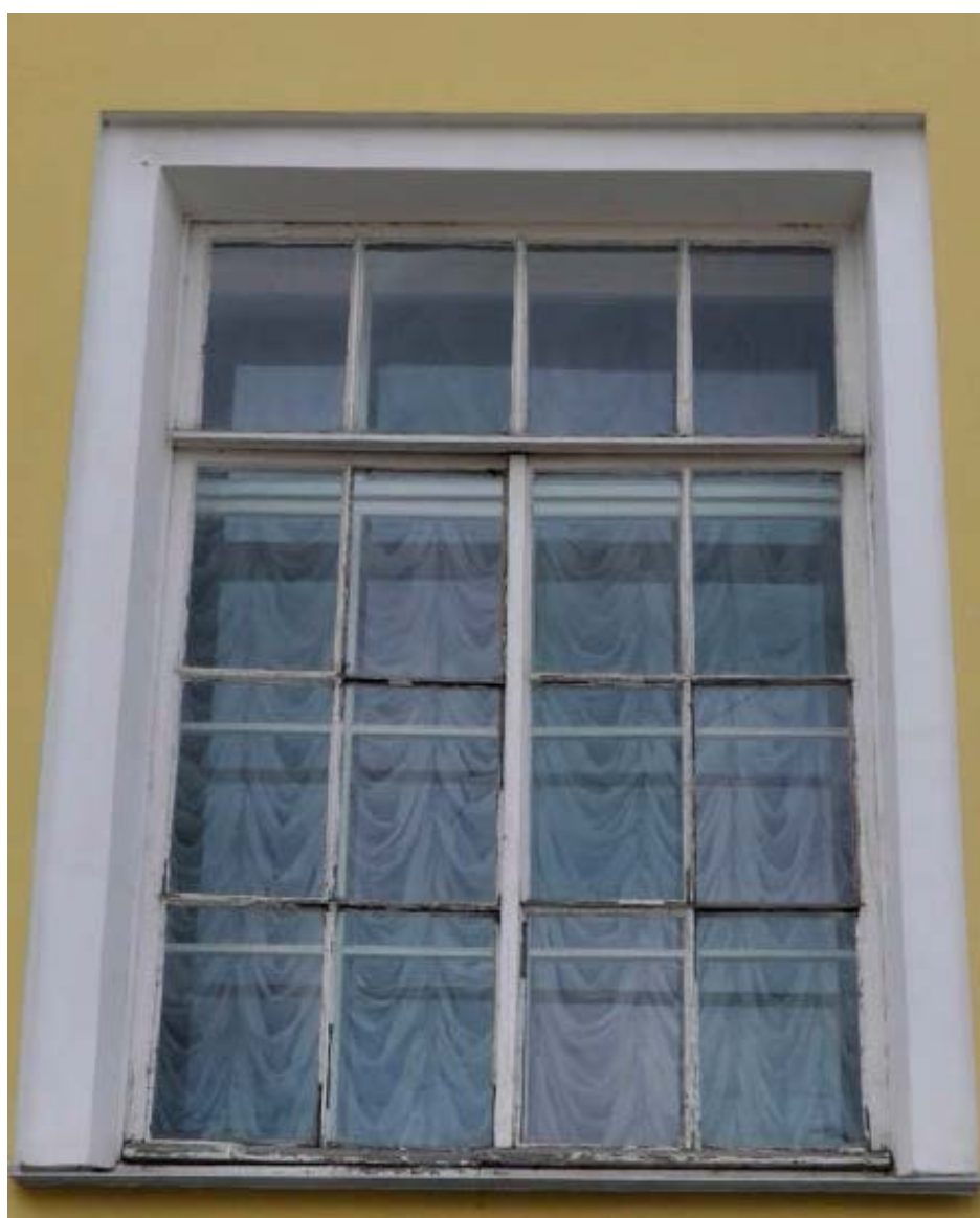
11. Оконное заполнение в уровне 1-ого этажа на дворовом фасаде объекта культурного наследия федерального значения «Дворец Таврический. Дворец», расположенного по адресу: г. Санкт-Петербург, ул. Шпалерная, д. 47, лит. А. 15.12.2022
