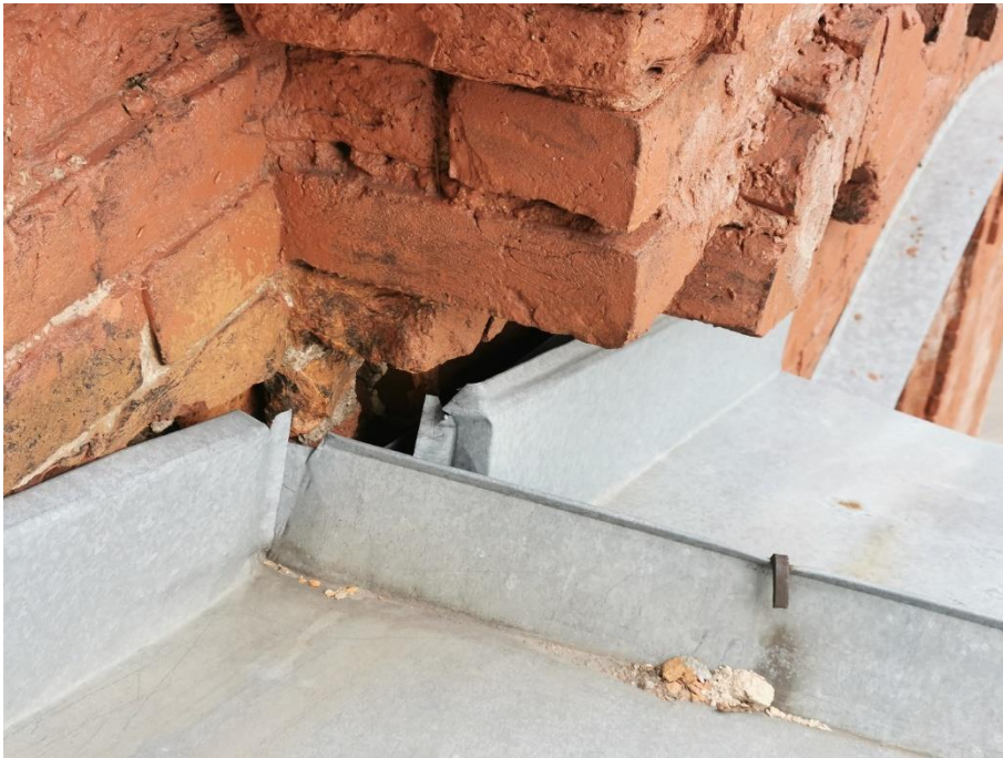
39. «Машинное отделение №2 с конторой главного механика» в составе ансамбля «Комплекс главной станции Санкт-Петербургских городских водопроводов», ул. Шпалерная, д. 56, лит. Е. Крыша. Фрагмент. Фото 08.08.2022г.
