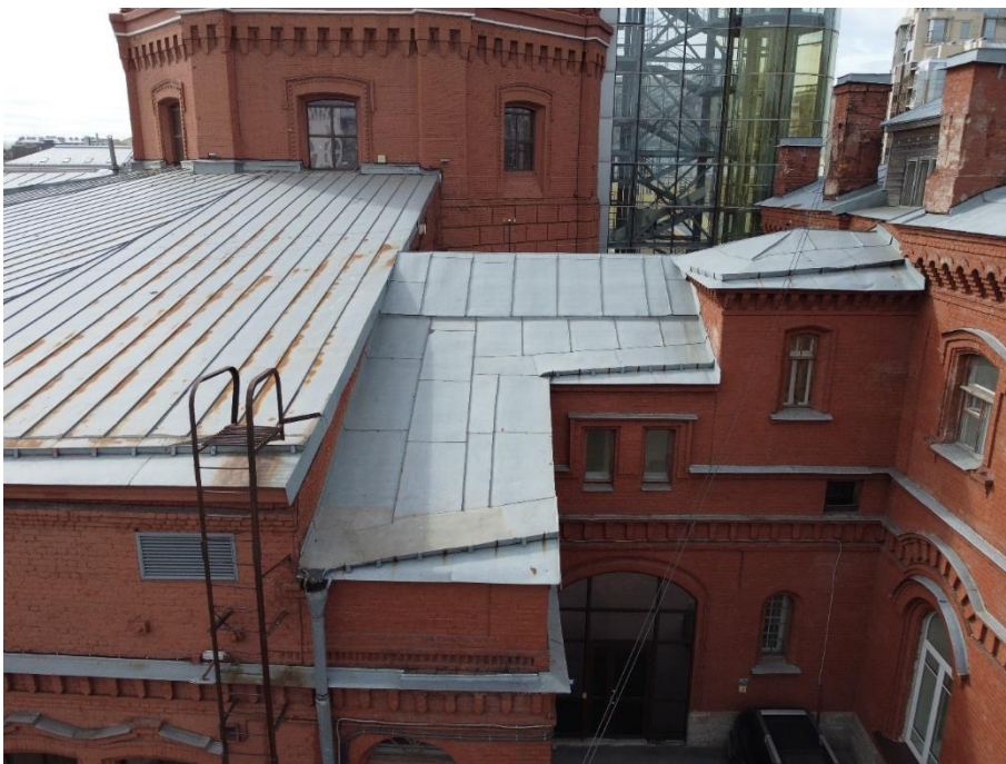
22. «Машинное отделение №2 с конторой главного механика» в составе ансамбля «Комплекс главной станции Санкт-Петербургских городских водопроводов», ул. Шпалерная, д. 56, лит. Е. Крыша. Общий вид. Фото 08.08.2022г.
