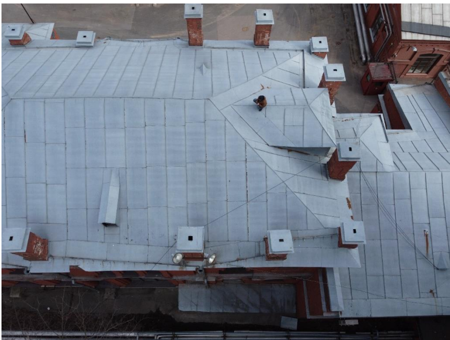
30. «Машинное отделение №2 с конторой главного механика» в составе ансамбля «Комплекс главной станции Санкт-Петербургских городских водопроводов», ул. Шпалерная, д. 56, лит. Е. Крыша. Общий вид. Фото 08.08.2022г.
