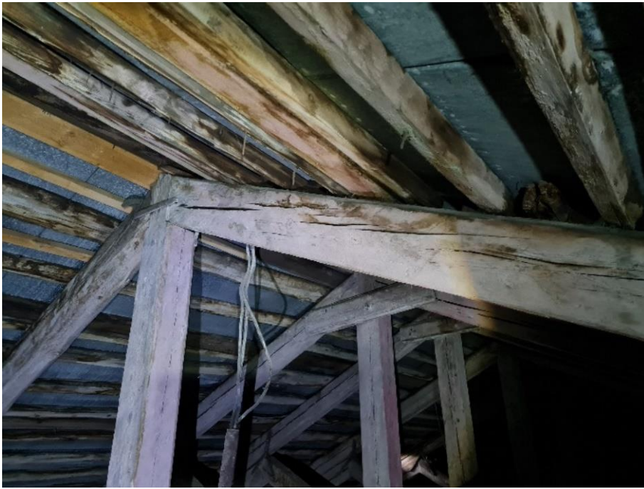
21. «Машинное отделение №2 с конторой главного механика» в составе ансамбля «Комплекс главной станции Санкт-Петербургских городских водопроводов», ул. Шпалерная, д. 56, лит. Е. Чердак. Фрагмент. Фото 08.08.2022г.
