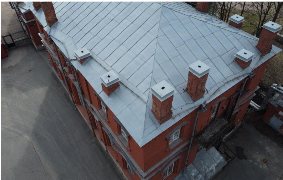
26. «Машинное отделение №2 с конторой главного механика» в составе ансамбля «Комплекс главной станции Санкт-Петербургских городских водопроводов», ул. Шпалерная, д. 56, лит. Е. Крыша. Общий вид. Фото 08.08.2022г.
