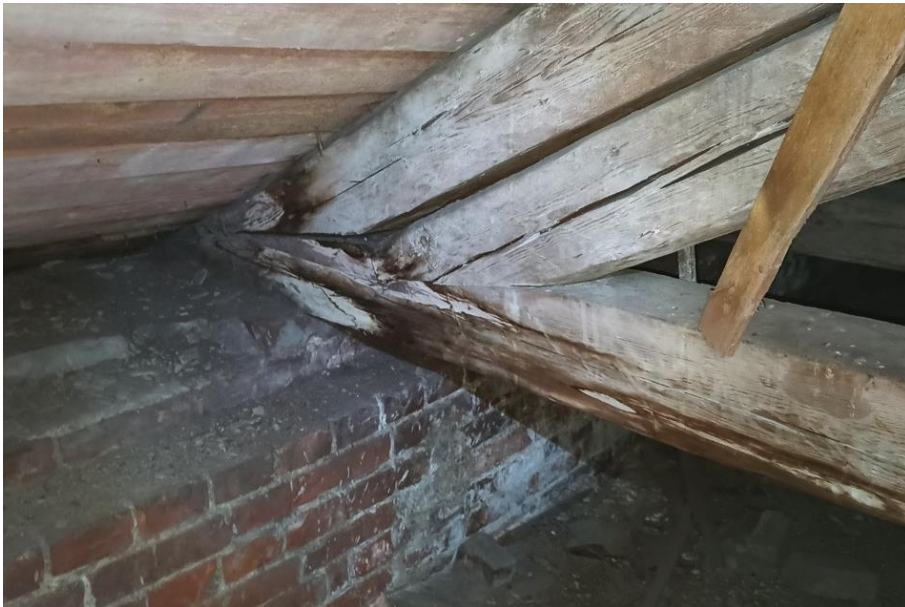
19. «Машинное отделение №2 с конторой главного механика» в составе ансамбля «Комплекс главной станции Санкт-Петербургских городских водопроводов», ул. Шпалерная, д. 56, лит. Е. Чердак. Фрагмент. Фото 08.08.2022г.
