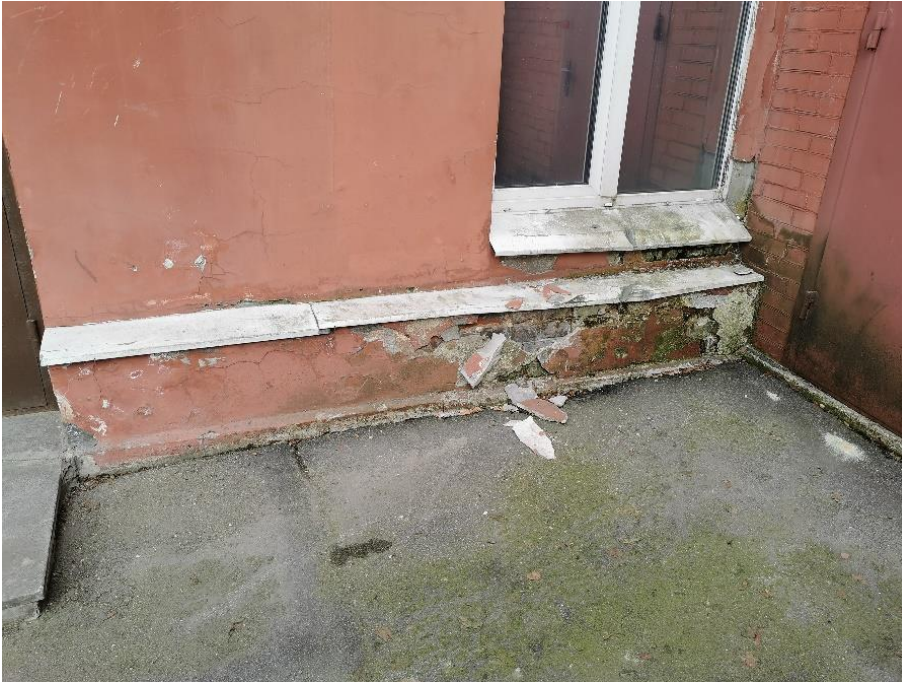
34. «Машинное отделение №6 с котельной» в составе ансамбля «Комплекс главной станции Санкт-Петербургских городских водопроводов», ул. Таврическая, д. 10, лит. А. Северный фасад. Фрагмент. Фото 08.08.2022г.
