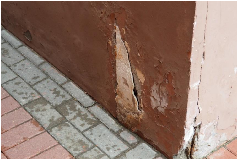
23. «Машинное отделение №6 с котельной» в составе ансамбля «Комплекс главной станции Санкт-Петербургских городских водопроводов», ул. Таврическая, д. 10, лит. А. Западный фасад. Фрагмент. Фото 08.08.2022г.
