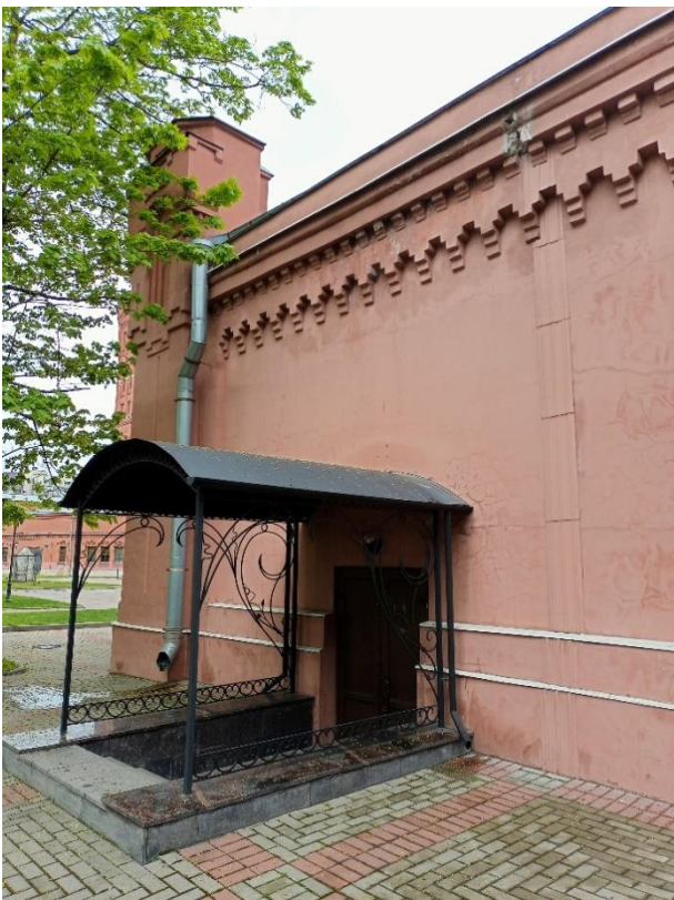
27. «Машинное отделение №6 с котельной» в составе ансамбля «Комплекс главной станции Санкт-Петербургских городских водопроводов», ул. Таврическая, д. 10, лит. А. Южный фасад. Фрагмент. Фото 08.08.2022г.
