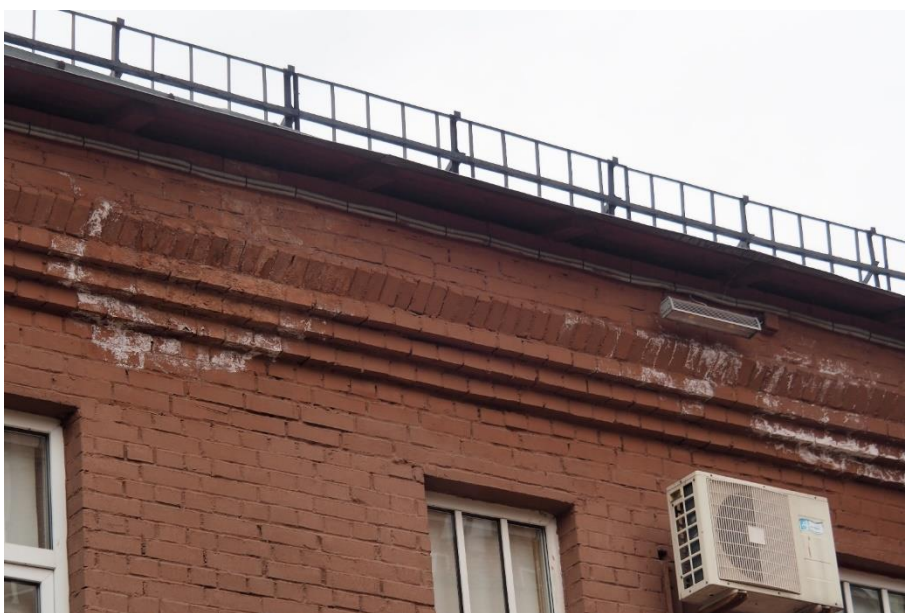
14. «Машинное отделение №3 с мастерскими и котельной и кладовые» в составе ансамбля «Комплекс главной станции Санкт-Петербургских городских водопроводов», ул. Шпалерная, д. 56, лит. АК. Восточный фасад. Фрагмент. Фото 08.08.2022г.
