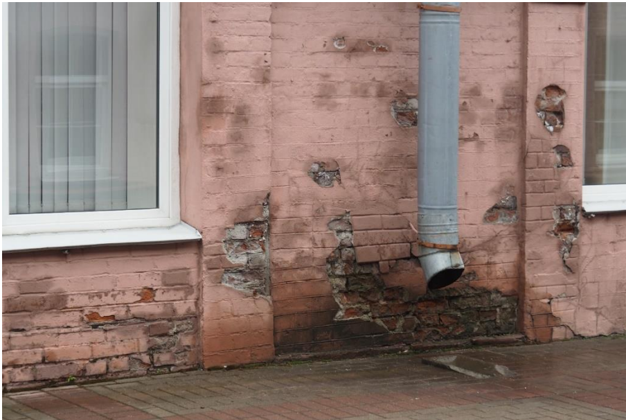
32. «Машинное отделение №3 с мастерскими и котельной и кладовые» в составе ансамбля «Комплекс главной станции Санкт-Петербургских городских водопроводов», ул. Шпалерная, д. 56, лит. АК. Западный фасад. Фрагмент. Фото 08.08.2022г.
