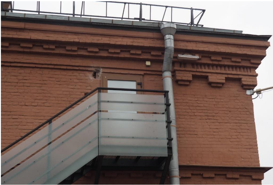
25. «Машинное отделение №3 с мастерскими и котельной и кладовые» в составе ансамбля «Комплекс главной станции Санкт-Петербургских городских водопроводов», ул. Шпалерная, д. 56, лит. АК. Северный фасад. Фрагмент. Фото 08.08.2022г.
