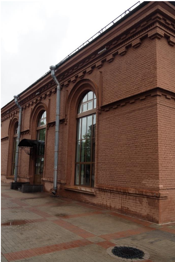
18. «Машинное отделение №3 с мастерскими и котельной и кладовые» в составе ансамбля «Комплекс главной станции Санкт-Петербургских городских водопроводов», ул. Шпалерная, д. 56, лит. АК. Восточный фасад. Фрагмент. Фото 08.08.2022г.
