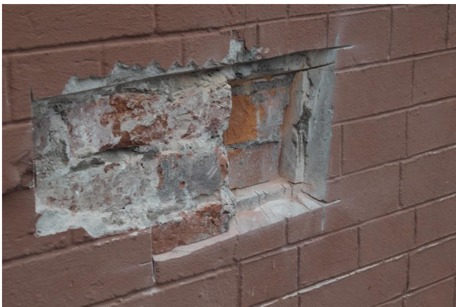
21. «Машинное отделение №3 с мастерскими и котельной и кладовые» в составе ансамбля «Комплекс главной станции Санкт-Петербургских городских водопроводов», ул. Шпалерная, д. 56, лит. АК. Северный фасад. Фрагмент. Фото 08.08.2022г.
