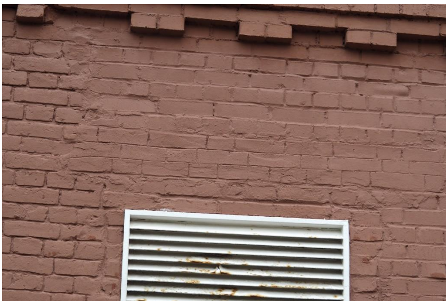
12. «Машинное отделение №3 с мастерскими и котельной и кладовые» в составе ансамбля «Комплекс главной станции Санкт-Петербургских городских водопроводов», ул. Шпалерная, д. 56, лит. АК. Восточный фасад. Фрагмент. Фото 08.08.2022г.
