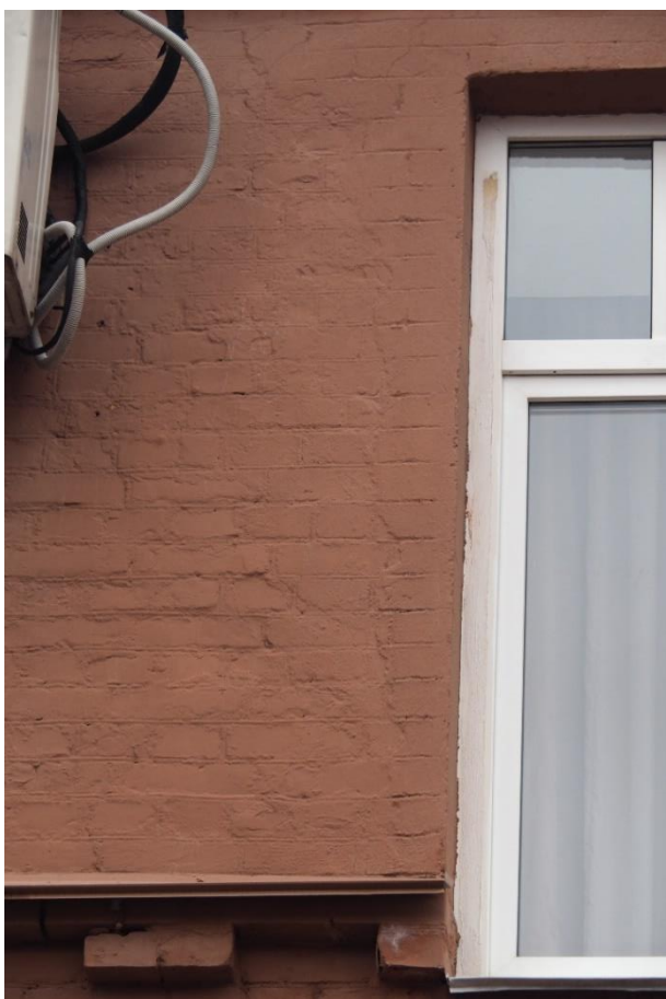
34. «Машинное отделение №3 с мастерскими и котельной и кладовые» в составе ансамбля «Комплекс главной станции Санкт-Петербургских городских водопроводов», ул. Шпалерная, д. 56, лит. АК. Западный фасад. Фрагмент. Фото 08.08.2022г.
