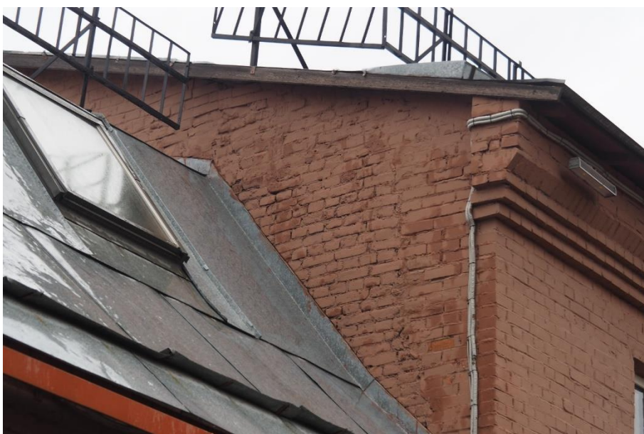
10. «Машинное отделение №3 с мастерскими и котельной и кладовые» в составе ансамбля «Комплекс главной станции Санкт-Петербургских городских водопроводов», ул. Шпалерная, д. 56, лит. АК. Восточный фасад. Фрагмент. Фото 08.08.2022г.
