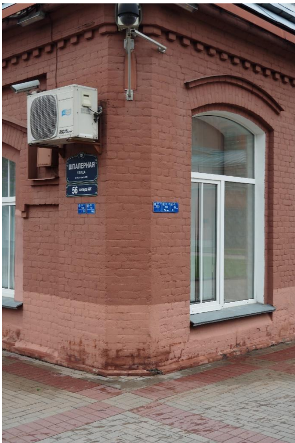
45. «Машинное отделение №3 с мастерскими и котельной и кладовые» в составе ансамбля «Комплекс главной станции Санкт-Петербургских городских водопроводов», ул. Шпалерная, д. 56, лит. АК. Южный фасад. Фрагмент. Фото 08.08.2022г.
