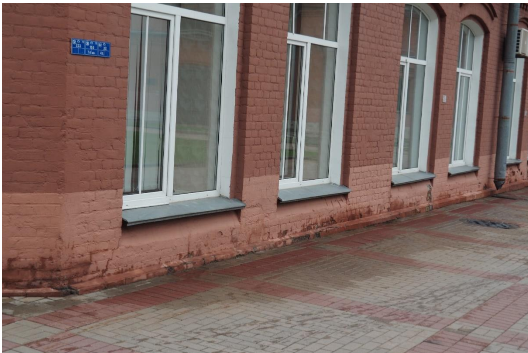
46. «Машинное отделение №3 с мастерскими и котельной и кладовые» в составе ансамбля «Комплекс главной станции Санкт-Петербургских городских водопроводов», ул. Шпалерная, д. 56, лит. АК. Южный фасад. Фрагмент. Фото 08.08.2022г.
