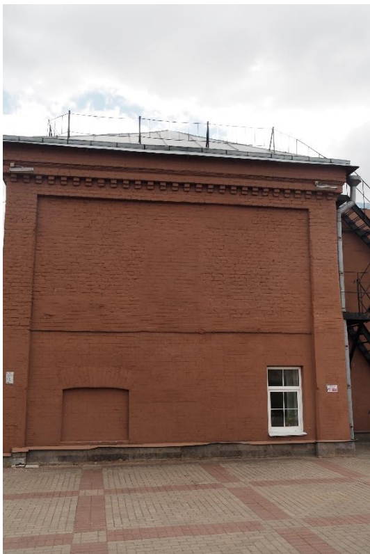
15. «Машинное отделение №3 с мастерскими и котельной и кладовые» в составе ансамбля «Комплекс главной станции Санкт-Петербургских городских водопроводов», ул. Шпалерная, д. 56, лит. АИ. Северный фасад. Общий вид. Фото 08.08.2022г.
