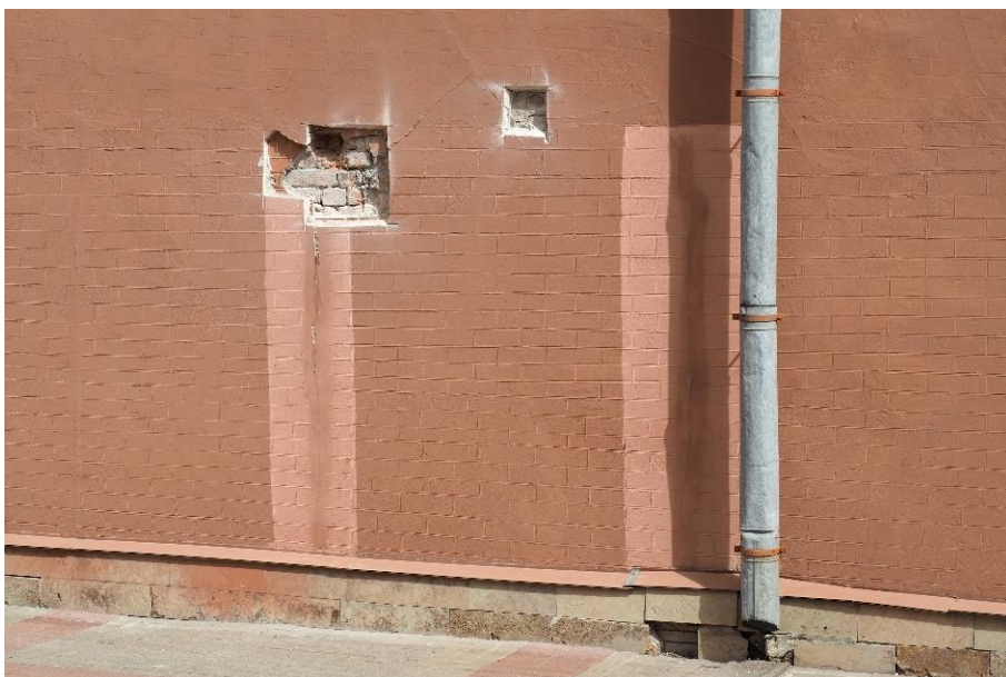
26. «Машинное отделение №3 с мастерскими и котельной и кладовые» в составе ансамбля «Комплекс главной станции Санкт-Петербургских городских водопроводов», ул. Шпалерная, д. 56, лит. АИ. Западный фасад. Фрагмент. Фото 08.08.2022г.
