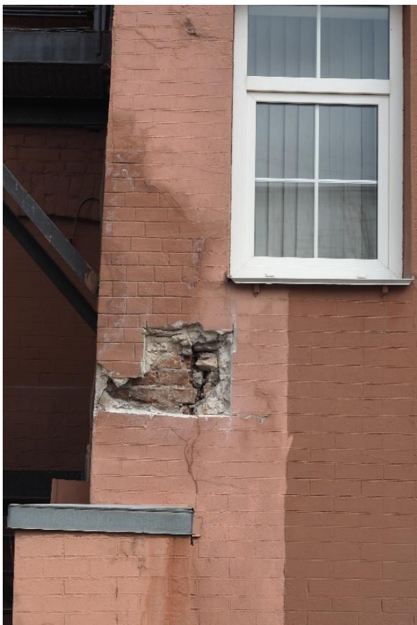
21. «Машинное отделение №3 с мастерскими и котельной и кладовые» в составе ансамбля «Комплекс главной станции Санкт-Петербургских городских водопроводов», ул. Шпалерная, д. 56, лит. АИ. Западный фасад. Фрагмент. Фото 08.08.2022г.
