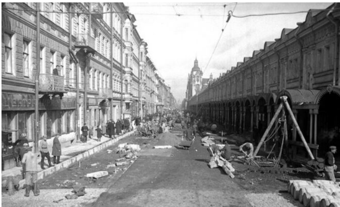
Илл. 23. Фото 1920-е гг. Дорожные работы на пр. Майорова (Вознесенском пр.) Укладка поребрика. Размещено на Retro View of Mankind's Habitat [Электронный ресурс]. Режим доступа: https://pastvu.com/ .
