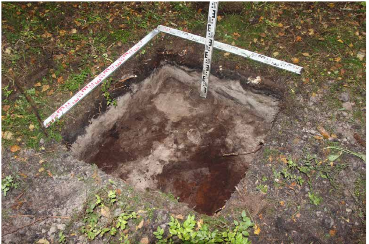
Рис. 40. Курортный район, ул. Танкистов-2022. Шурф 2, фиксация по уровню окончания работ, вид на северо-запад.
