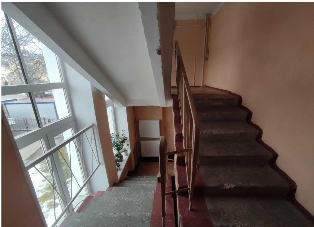
29. Объект культурного наследия регионального значения «Женская гимназия Павловой», расположенный по адресу: Санкт-Петербург, город Петергоф, Эрлеровский бульвар, дом 1/35, литера А. Общий вид лестницы 1ЛК.
