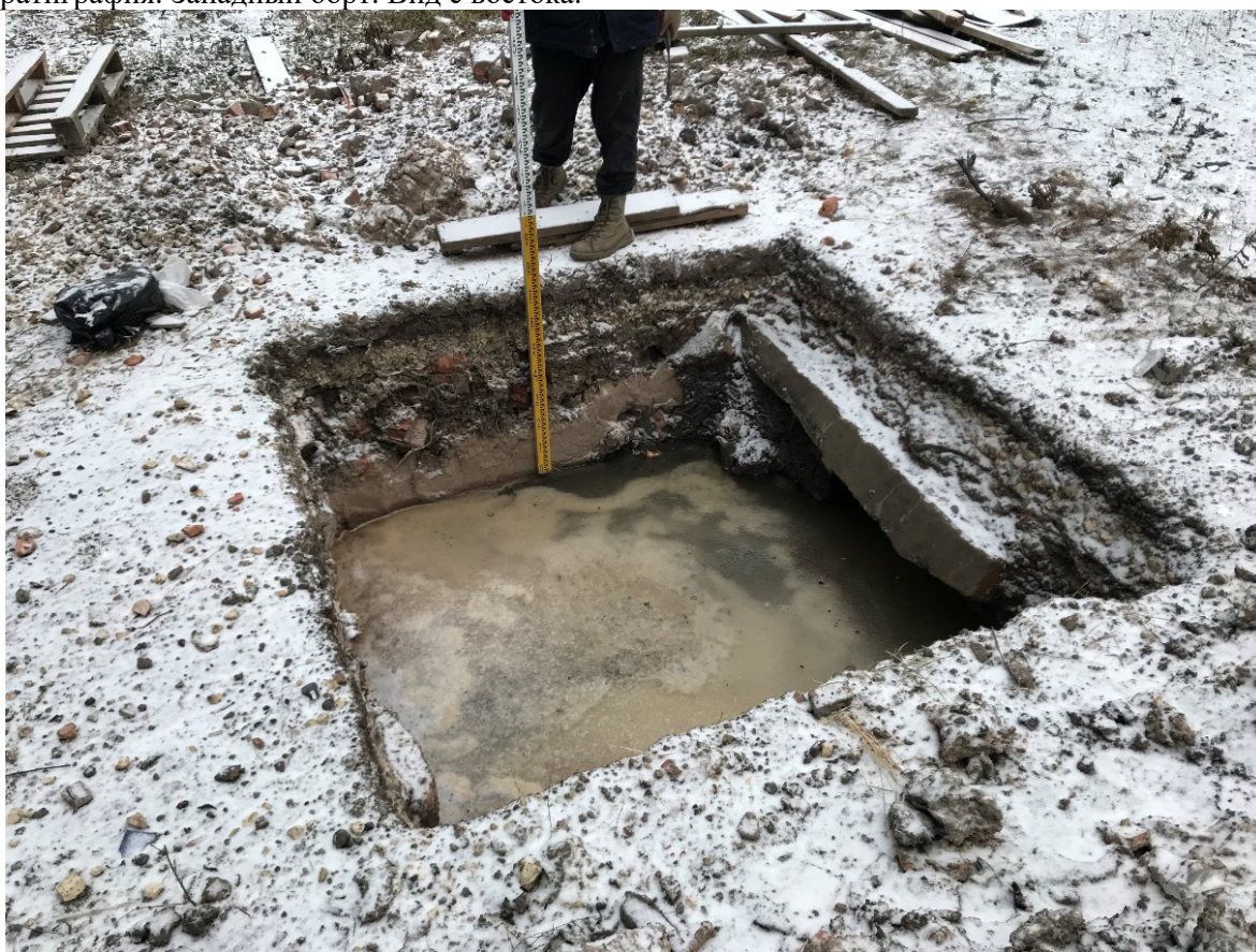
Рис. 59. Санкт-Петербург, ул. Киевская д. 5, кадастровый участок № 78:14:0007525:3838. Шурф 2 после окончания земляных работ. Подъем воды в шурфе спустя сутки. Вид с юго-запада.
