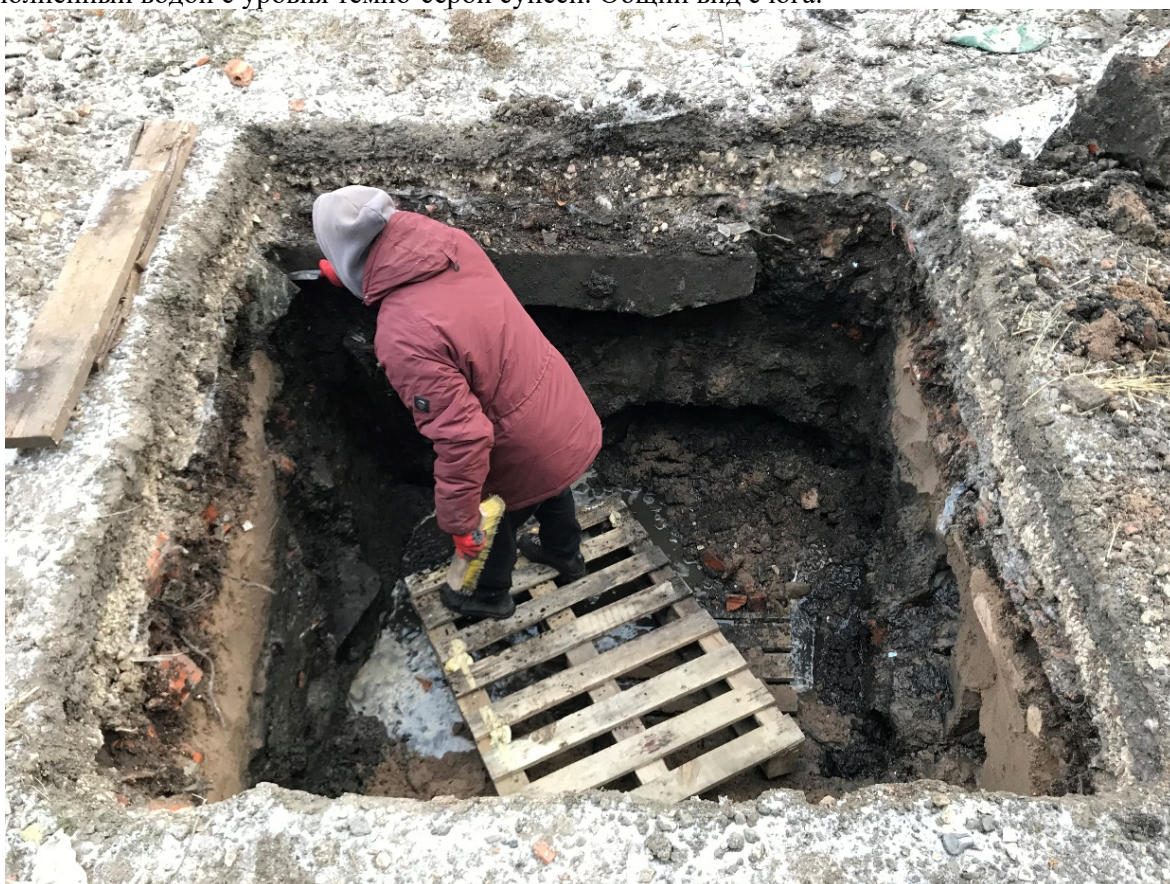
Рис. 53. Санкт-Петербург, ул. Киевская д. 5, кадастровый участок № 78:14:0007525:3838. Шурф 2 процесс зачистки бортов. Рабочий момент. Общий вид с запада.
