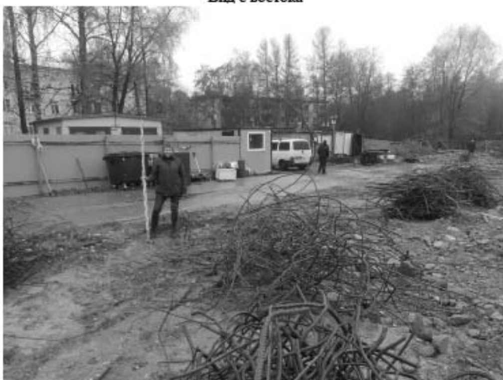
Рис. 19. г. Санкт-Петербург, Курортный район, г. Зеленогорск. Участок с кадастровым номером 78:38:0022464:1148 Точка фотофиксации 2 Общий вид на территорию демонтажа бетонной постройки Вид с севера
