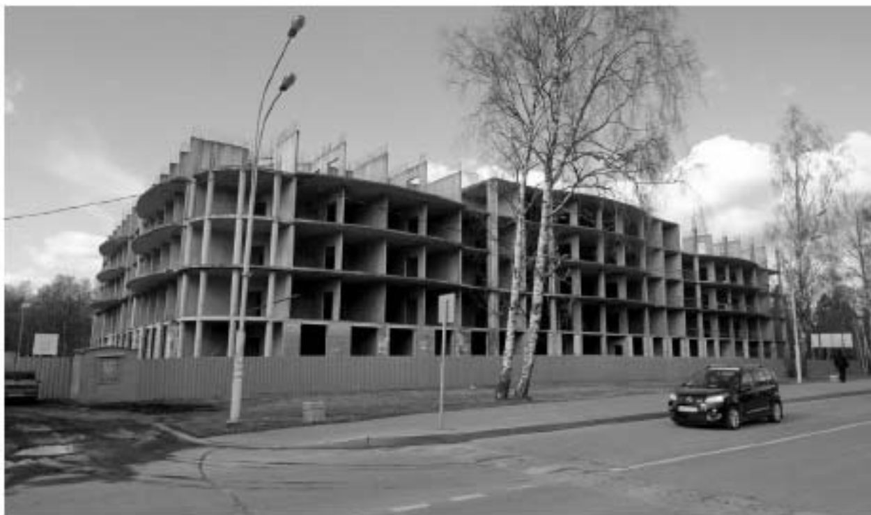
Рис. 5. г. Санкт-Петербург, Курортный район, г. Зеленогорск. Недостроенное здание по адресу пр. Ленина, д. 38, лит. А // http://kanoner.com/2022/10/07/172356/
