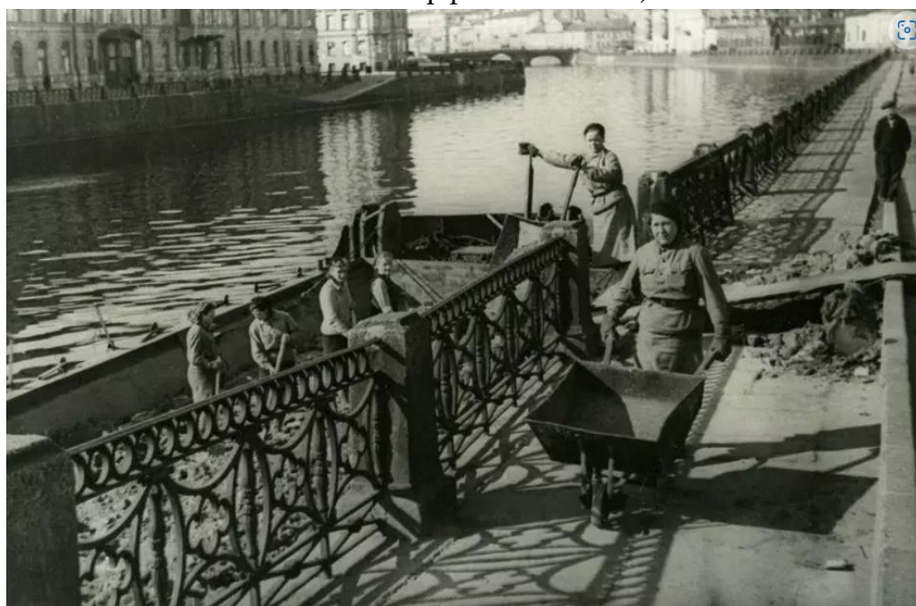
Илл. 18. Погрузка стройматериалов на баржи для восстановления городского хозяйства Ленинграда. Набережная реки Фонтанки. 12.05.1944 г. (источник: https://pastvu.com/p/1198790 ).
