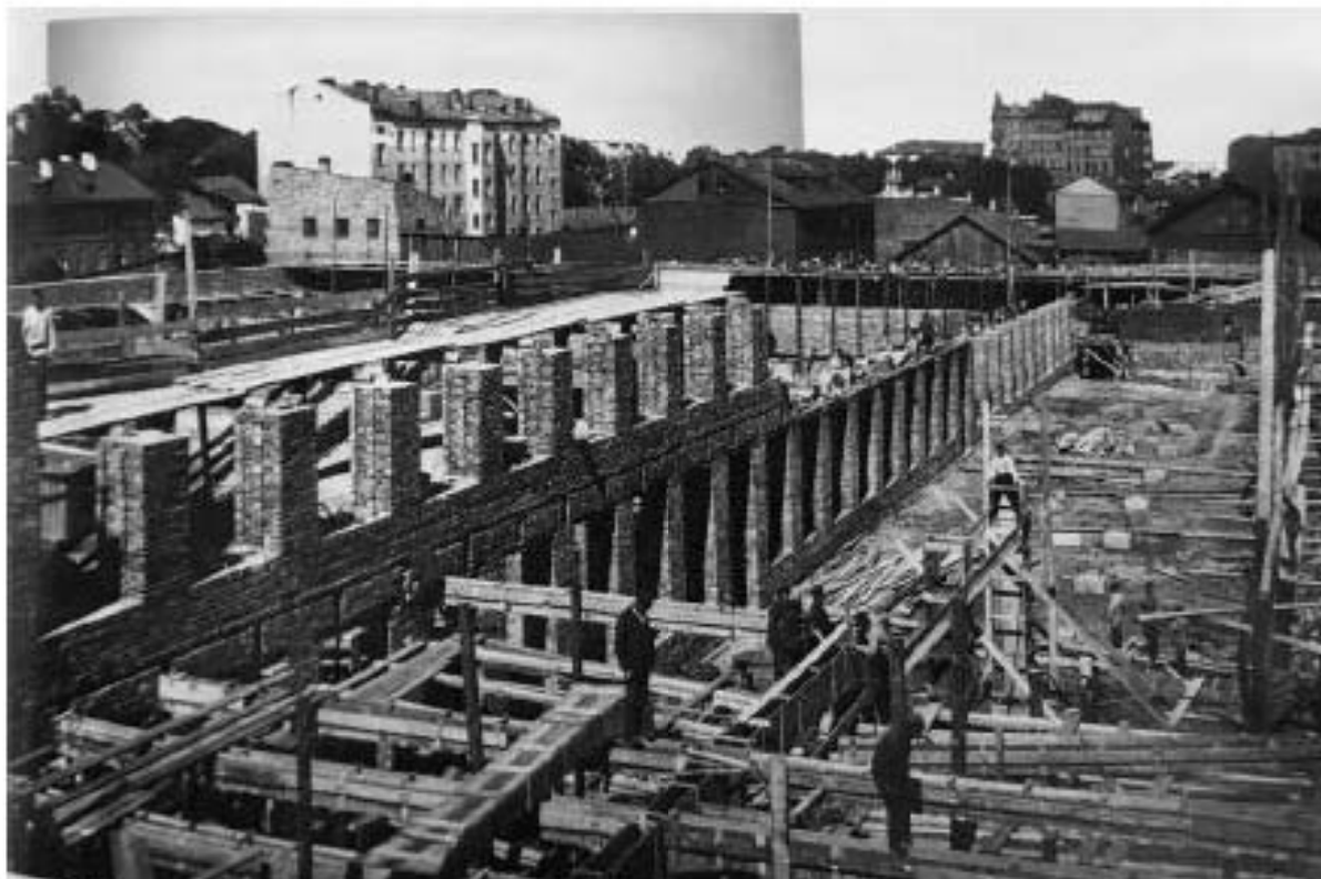
Илл. 68 Строительство цехов акционерного общества русских электротехнических заводов «Сименс и Гальске». (В.О., Кожевенная линия, д.39). // [Электронный ресурс]:URL: http://pastvu.com .
