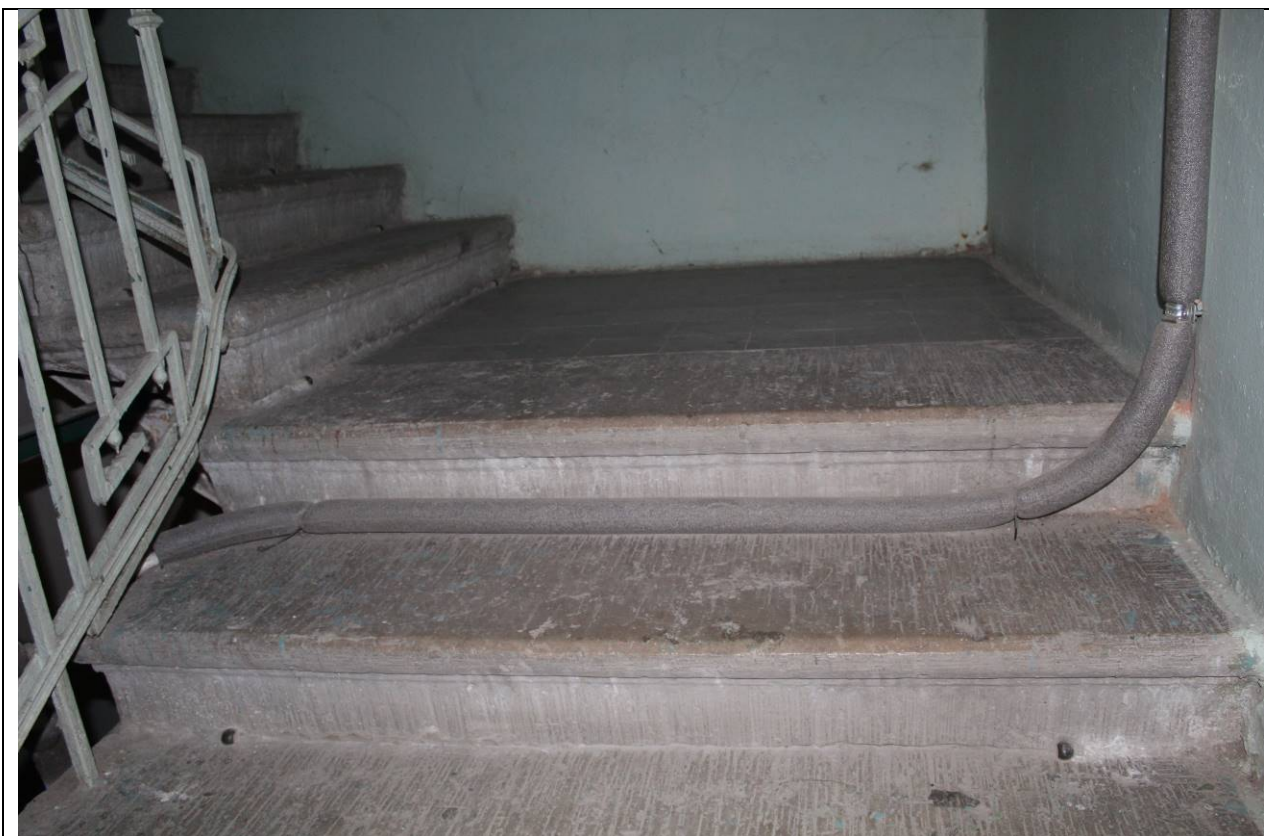
18. Дом А. Ф. Пеля. Шпалерная ул., 5. ЛК-1. Ступени лещадной плиты с валиком. Фото: эксперт А. А. Кононов, 26.04.2021.
