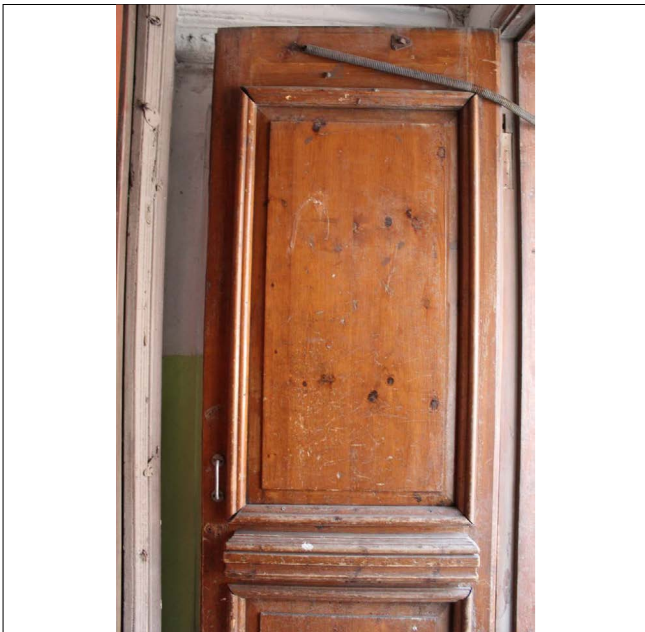
3. Дом А. Ф. Пеля. Шпалерная ул., 5. ЛК-1. Заполнение дверного проема. Фрагмент. Фото: эксперт А. А. Кононов, 26.04.2021.
