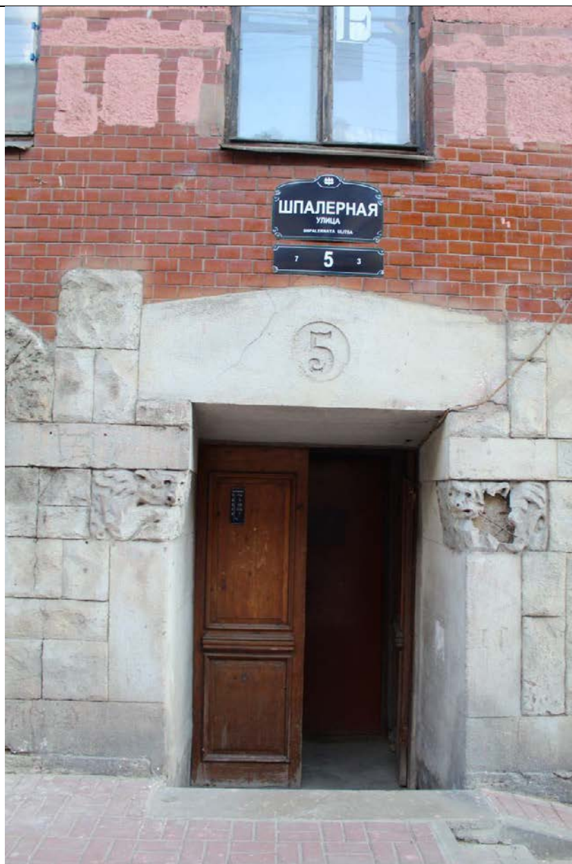
6. Дом А. Ф. Пеля. Шпалерная ул., 5. Фрагмент лицевого фасада. Дверной проем. Вид с севера. Фото: эксперт А. А. Кононов, 26.04.2021.
