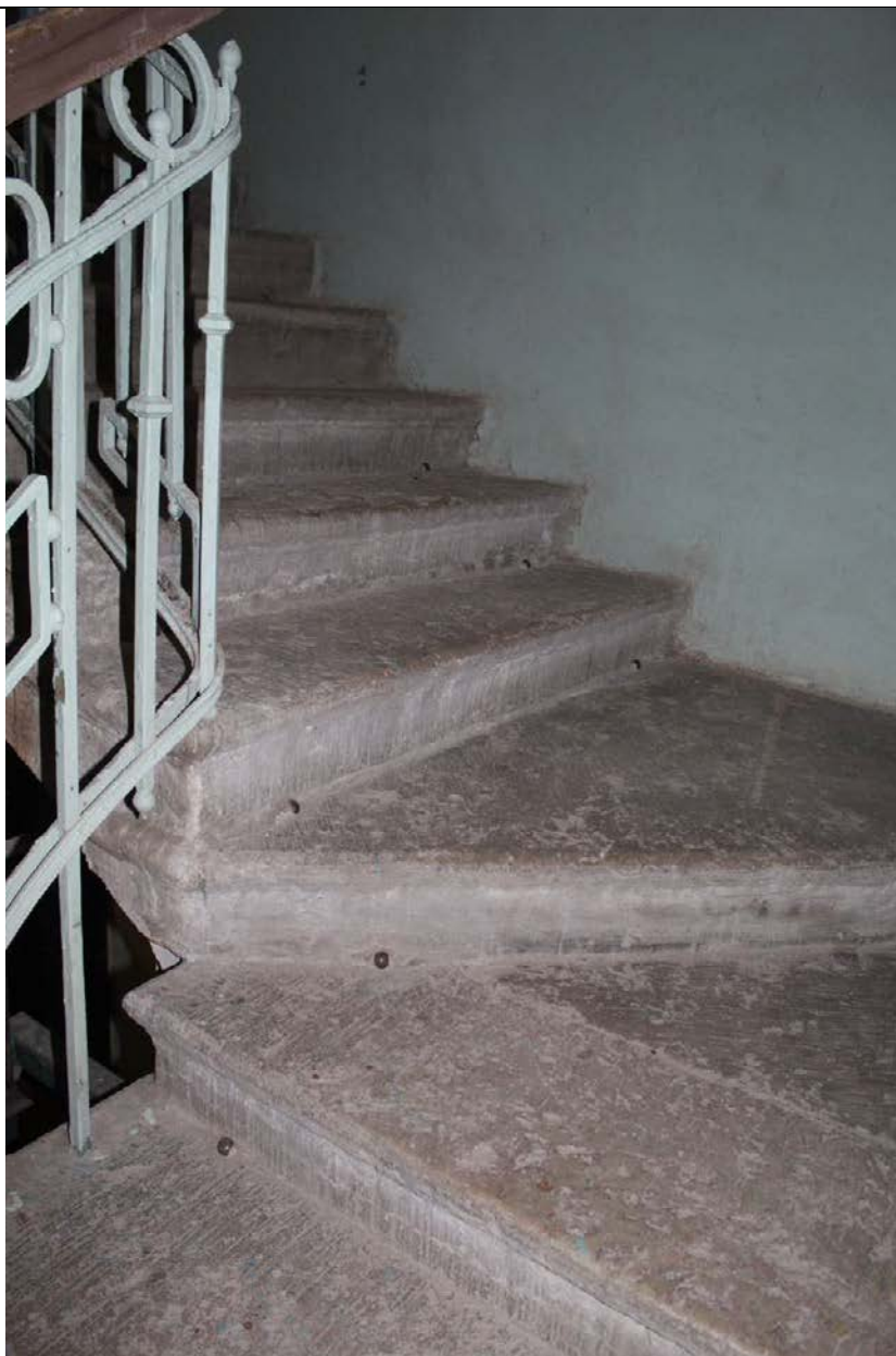
19. Дом А. Ф. Пеля. Шпалерная ул., 5. ЛК-1. Лестничные марши на чердак. Забежные ступени. Фрагмент. Фото: эксперт А. А. Кононов, 26.04.2021.
