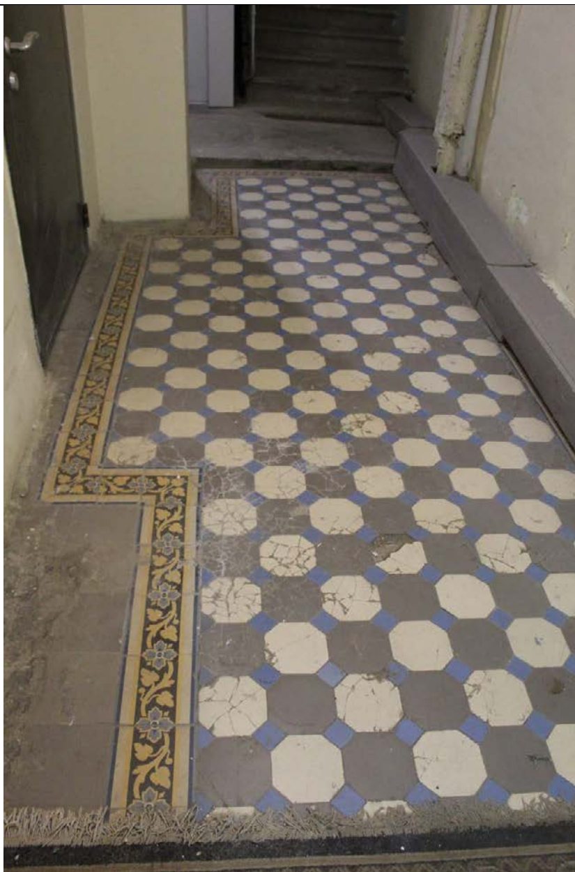
8. Дом А. Ф. Пея. Шпалерная ул., 5. ЛК-1. Напольное покрытие вестибюля. Фото: эксперт А. А. Кононов, 26.04.2021.
