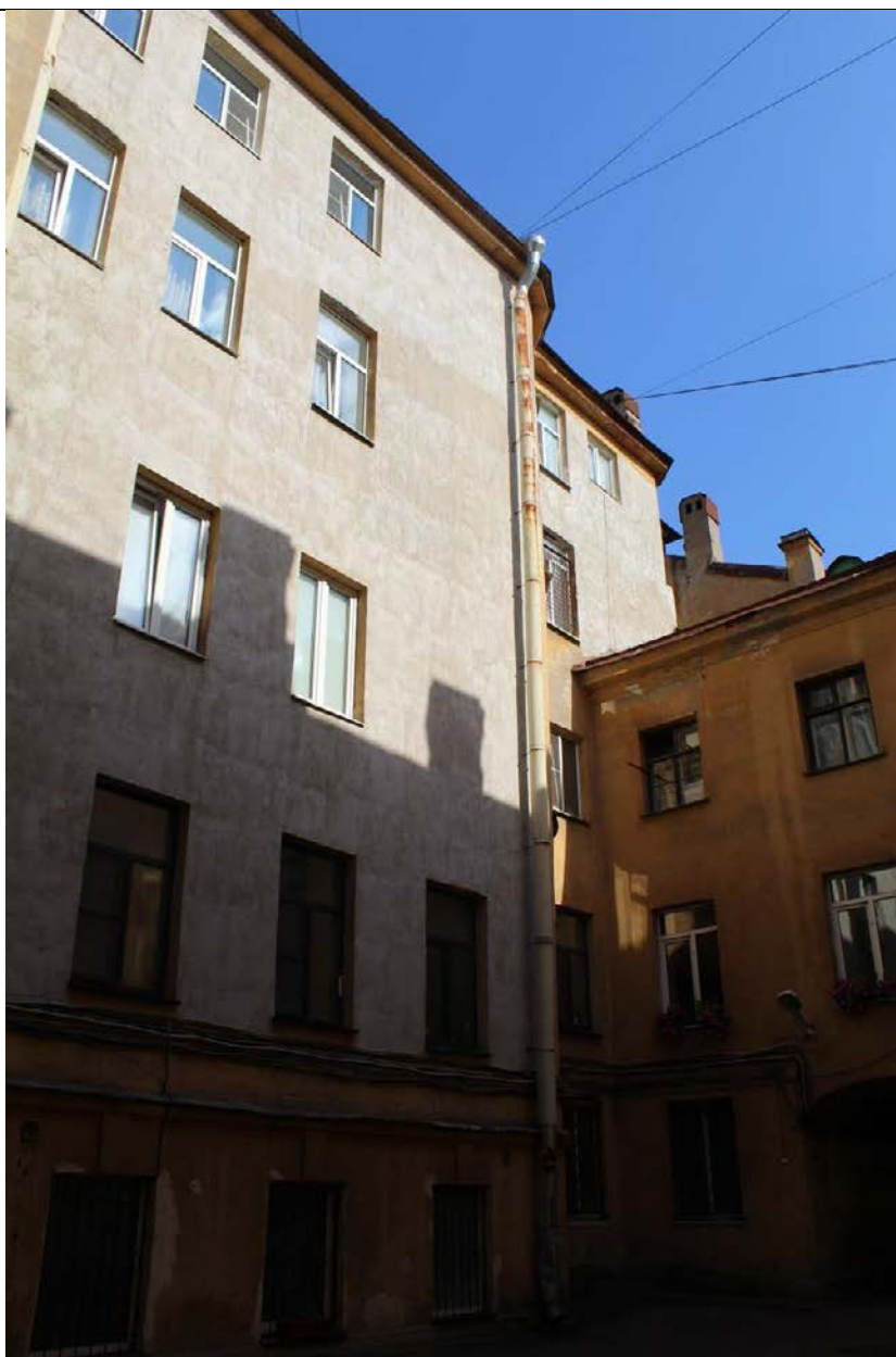
15. Дом А. Ф. Песя. Шпалерная ул., 5. Северный двор. Дворовый фасад северо-восточного дворового флигеля. Вид с северо-запада. Фото: эксперт А. А. Кононов, 26.04.2021.
