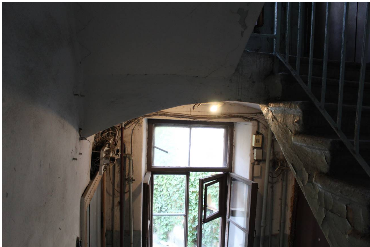
6. Дом А. Ф. Пеля. Шпалерная ул., 5. Южный двор. Юго-западный дворовый флигель. Своды перекрытия между 2 и 3 этажами. Фото: эксперт А. А. Кононов, 01.06.2021.
