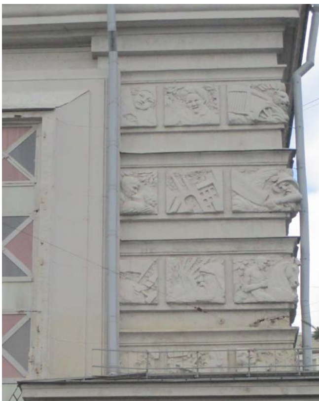
15. г.Санкт-Петербург, Кондратьевский проспект, дом 44, литера А. Фрагмент южного фасада. восточная барельефная композиция.
