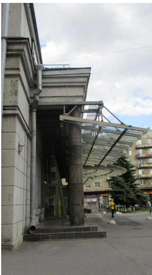
10. г.Санкт-Петербург, Кондратьевский проспект, дом 44, литера А. Колоннада портика южного фасада. Вид с запада.
