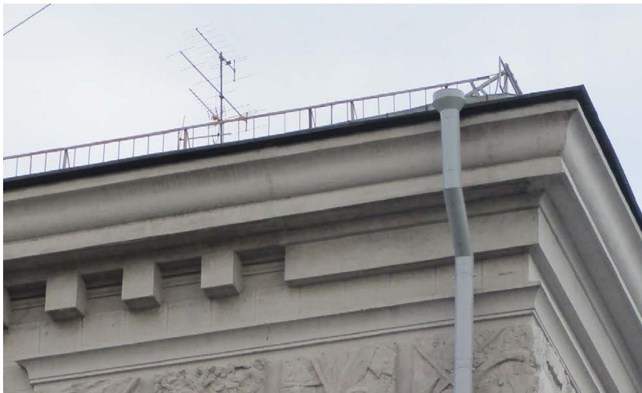
22. г.Санкт-Петербург, Кондратьевский проспект, дом 44, литера А. Венчающий карниз центрального, 4-х этажного объема.
