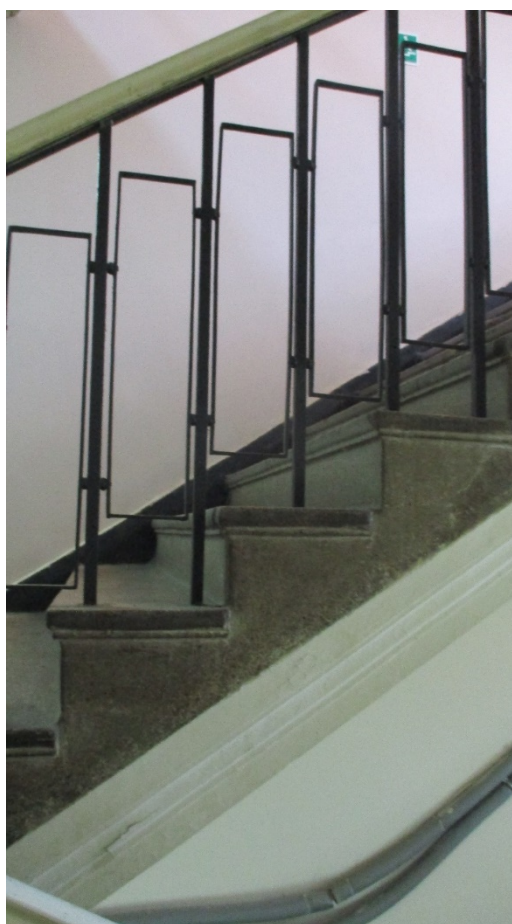
10. г.Санкт-Петербург, Кондратьевский проспект, дом 44, литера А. Интерьер. Лестница восточного объема (центральная). Ограждение марша.
