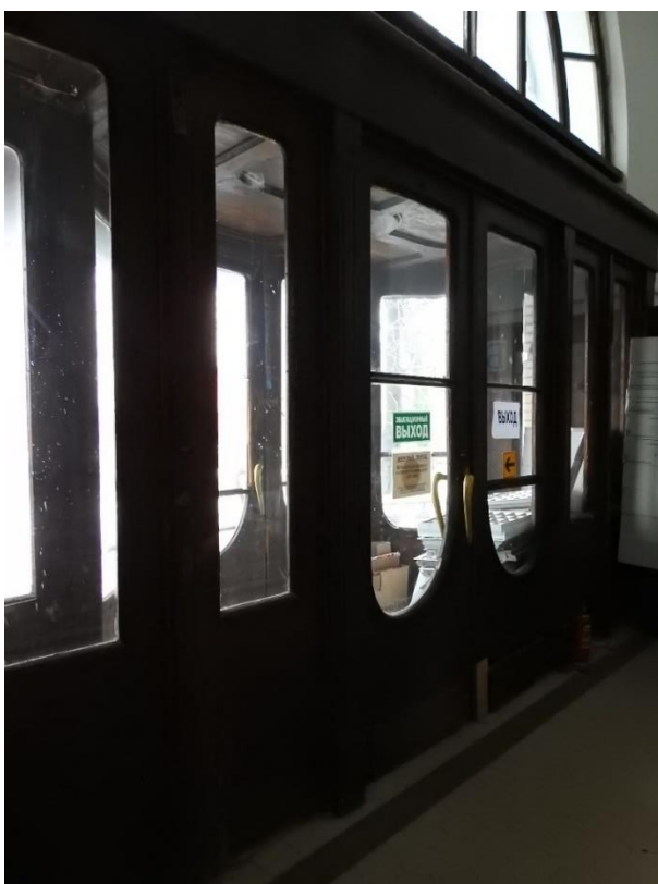
22. «Главное здание», входящее в состав объекта культурного наследия федерального значения «Институт ортопедический», Александровский парк, д.5 литера А. Главный вход. Общий вид тамбура со стороны вестибюля. Фото 11.03.2021 г.
