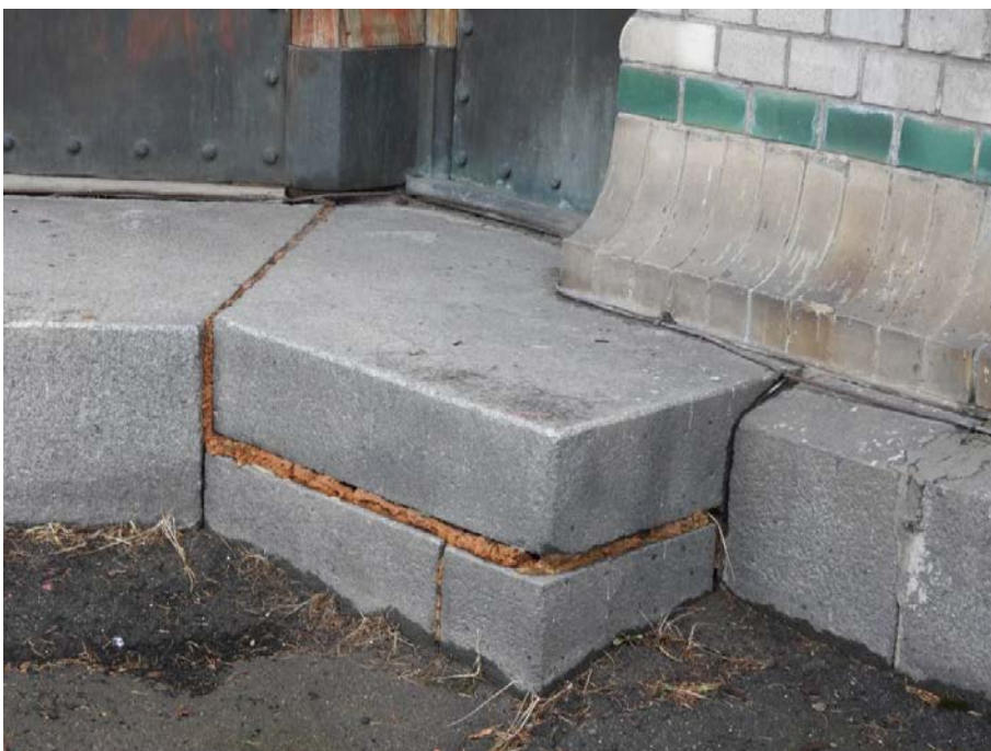
17. «Главное здание», входящее в состав объекта культурного наследия федерального значения «Институт ортопедический», Александровский парк, д.5 литера А. Главный вход. Фрагмент. Фото 11.03.2021 г.
