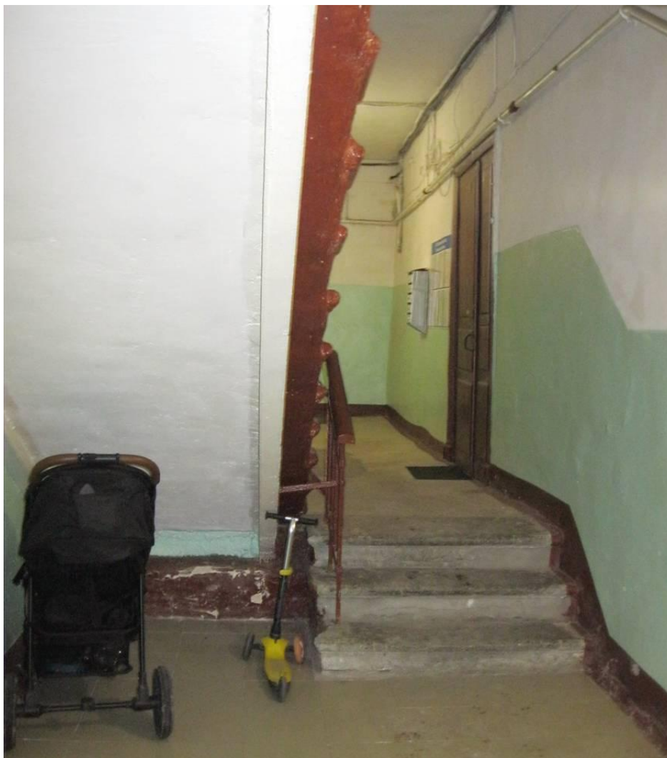
10. Выявленный объект культурного наследия «Дома И.А.Брылкина (2 здания)». Общий вид лестничной клетки. Вид от входа с улицы.
