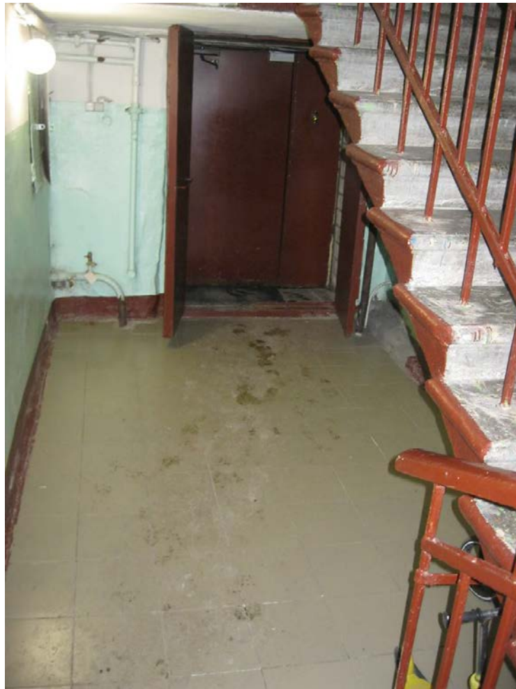
11. Выявленный объект культурного наследия «Дома И.А.Брылкина (2 здания)». Общий вид лестничной клетки. Вид на вход с улицы.
