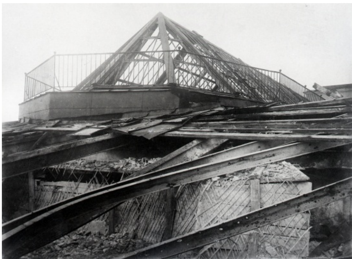
80. Повреждение светового фонаря восточного крыла здания музея зимой 1941 года. 1944. https://ethnomuseum.ru/ .
