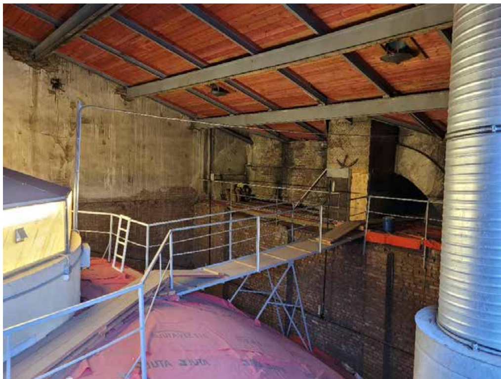
26. Вид на историческую внутреннюю капитальную стену. Фрагмент. ОКНФЗ «Корпус Этнографического отдела Русского музея (Этнографический музей)», входящий в состав ансамбля объекта ОКНФЗ «Дворец Великого князя Михаила Павловича (Русский музей Императора Александра III)», расположенный по адресу: Санкт-Петербург, ул. Инженерная, дом 4/1, литера Е (Инженерная ул., 4-а). Дата съемки: 28.02.2022.
