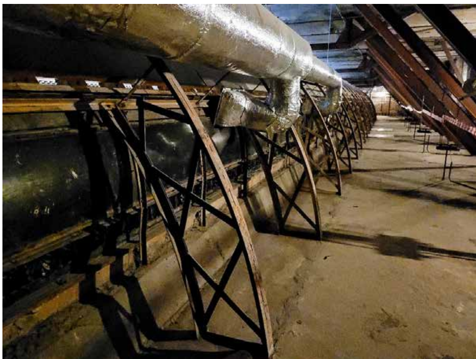
19. Фрагмент конструктивной системы. ОКНФЗ «Корпус Этнографического отдела Русского музея (Этнографический музей)», входящий в состав ансамбля объекта ОКНФЗ «Дворец Великого князя Михаила Павловича (Русский музей Императора Александра III)», расположенный по адресу: Санкт-Петербург, ул. Инженерная, дом 4/1, литера Е (Инженерная ул., 4-а). Дата съемки: 28.02.2022.
