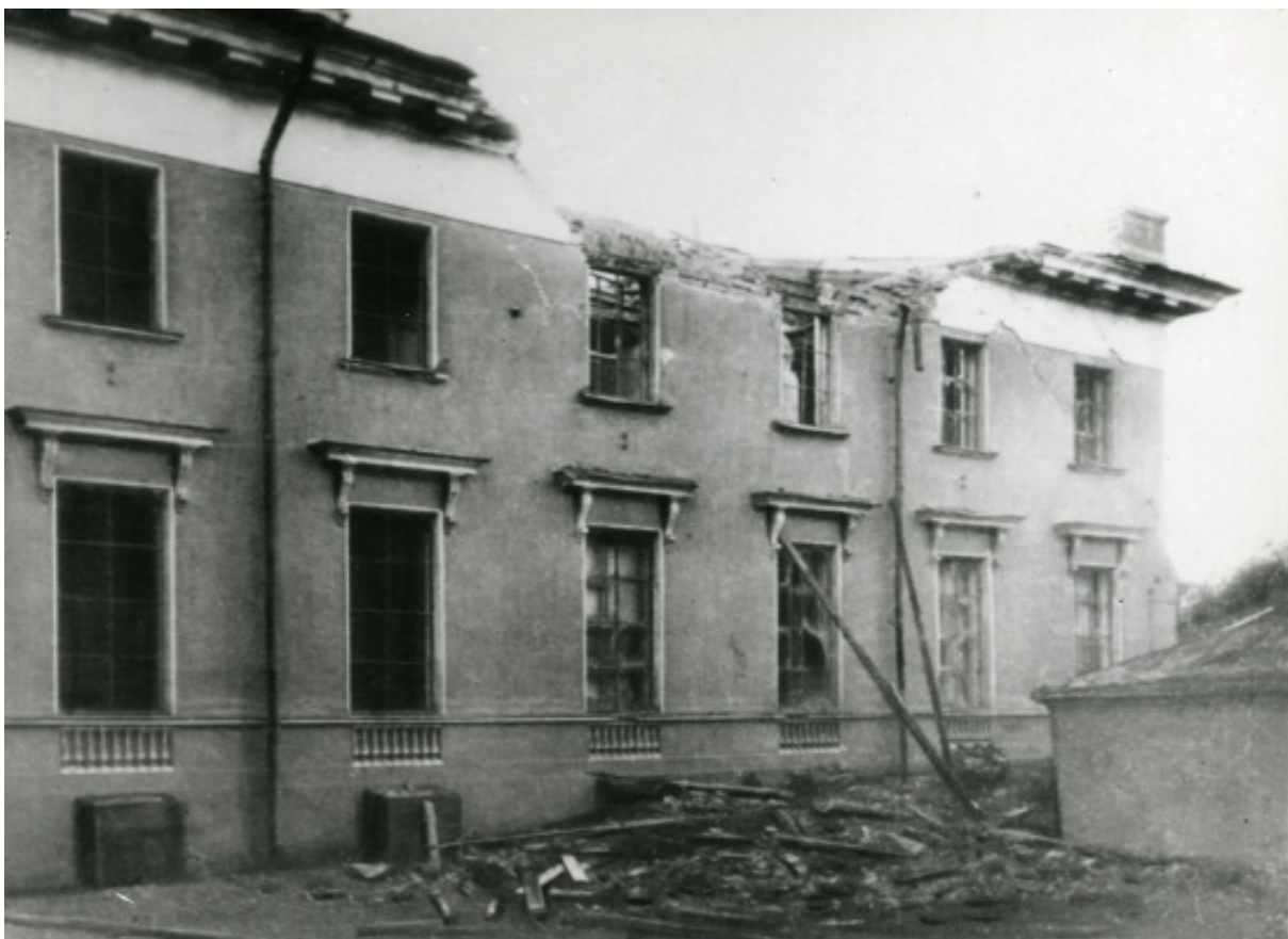
67. Разрушения правого (восточного) крыла главного корпуса музея после попадания первой бомбы осенью 1941 года. 1943. https://ethnomuseum.ru/ .
