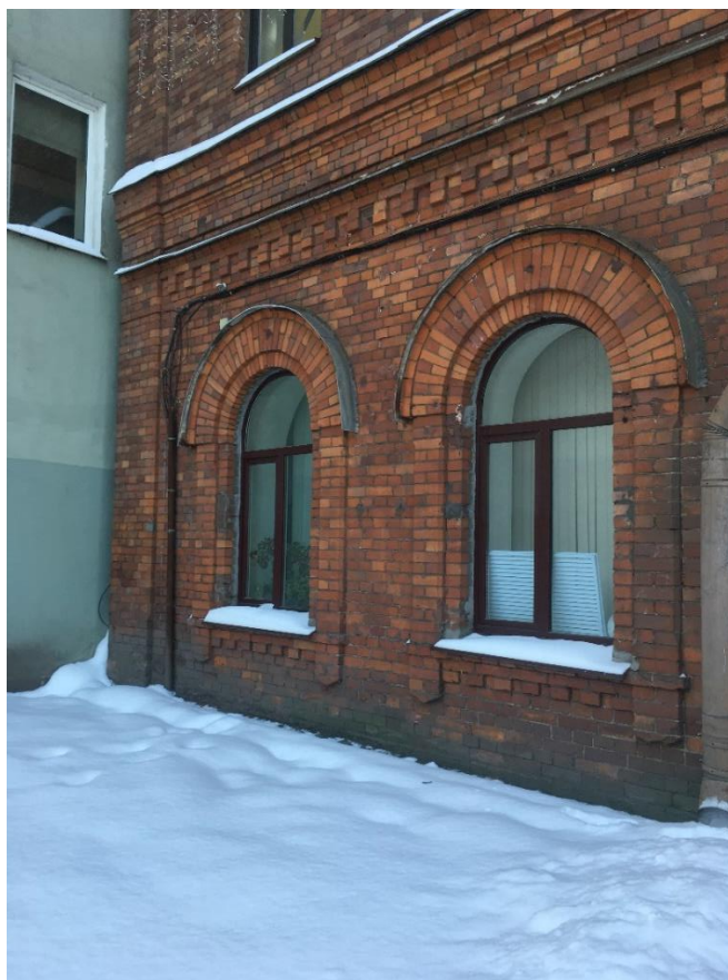
Фото 3. Фрагмент лицевого фасада по Московскому проспекту по оси «А» в осях «1-2». Локальные докомпоновки кладки. Загрязнение цокольной части.
