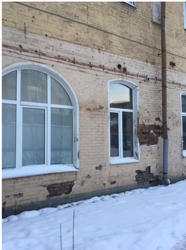
Фото 14. Фрагмент стены м/о «6-5» в уровне 1-го этажа по оси «Е». Биопоражения в цокольной части стены. Отсутствие цоколя. Следы крепления инженерных сетей.
