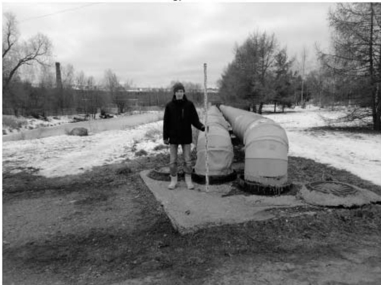
Рис. 14. СПб 2022. Кронштадтский район. «Реконструкция тепловых сетей г. Кронштадт, вдоль Кронштадтского шоссе до ТК-21А на ул. Восстания» Точка фотофиксации 7, вид на юго-восток
