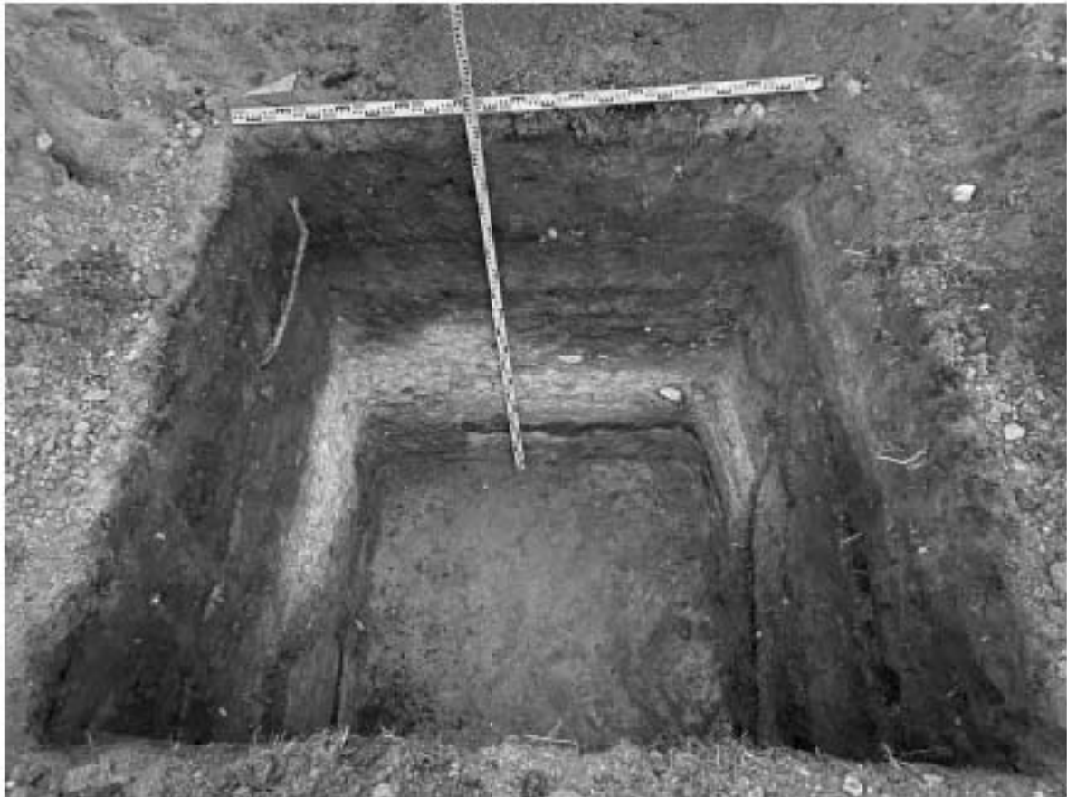
Рис. 26. СПб 2022. Кронштадтский район. «Реконструкция тепловых сетей г. Кронштадт, вдоль Кронштадтского шоссе до ТК-21А на ул. Восстания» Шурф 1, фиксация по материке, вид на восток
