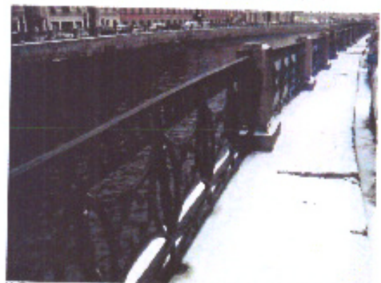
10. Переходное ограждение, тротуар (правый берег), на участке между Плещеевым и Пискаревским (Зеленом, Нарвским) мостами
