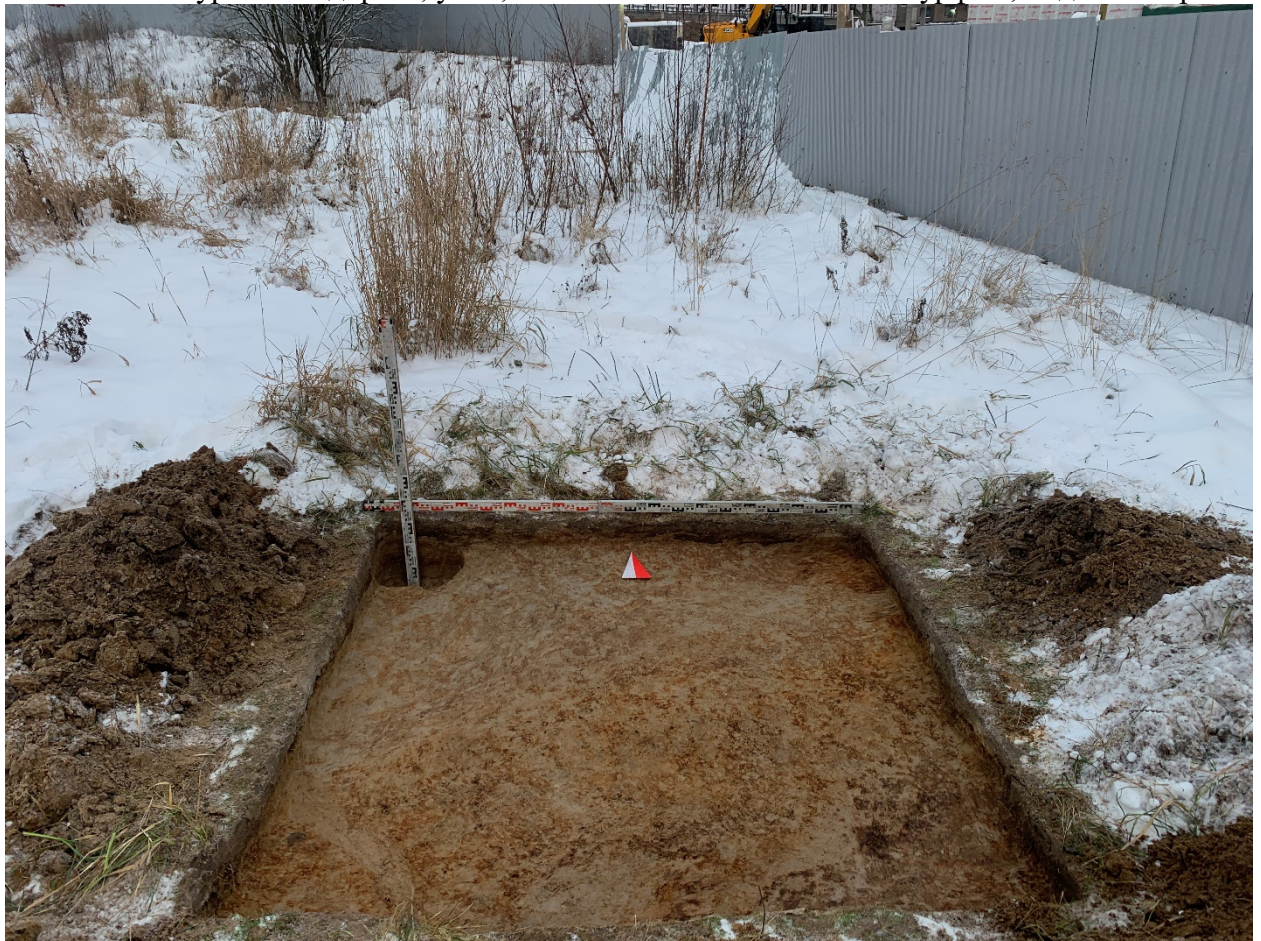
Рис. 29. Муринская дорога, уч. 4, КН:1008. Шурф 1, фиксация по уровню окончания работ, вид на север.
