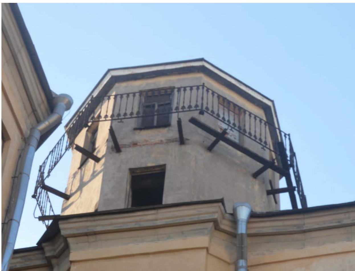
13. Выявленный объект культурного наследия «Дом Сироткиных». Башенный объем в завершении дворового (юго-восточного) фасада лицевого дома. Вид с юго-востока. Съемка 26.04.2021
