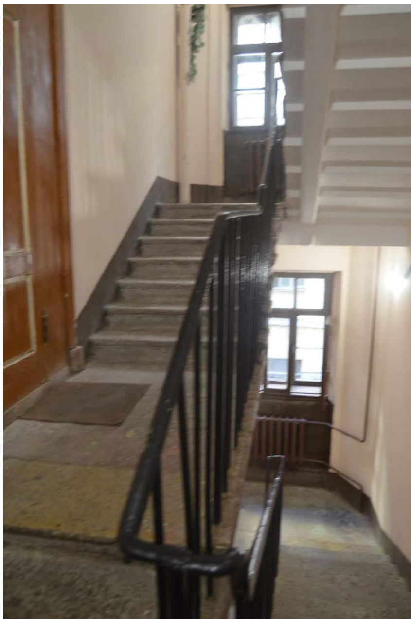
37. Выявленный объект культурного наследия «Дом Сироткиных». Лестница южного дворового флигеля (Л2). Конструкции лестничных маршей в уровне третьего этажа. Вид с северо-востока. Съемка 26.04.2021
