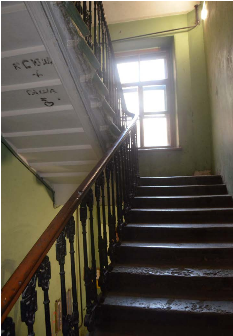
45. Выявленный объект культурного наследия «Дом Сироткиных». Лестница юго-восточного дворового флигеля (ЛЗ). Конструкция лестничных маршей. Вид с юго-востока. Съемка 26.04.2021.
