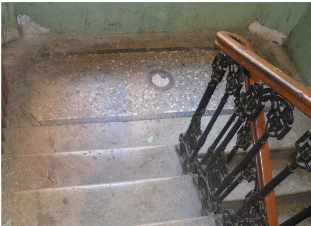
46. Выявленный объект культурного наследия «Дом Сироткиных». Лестница юго-восточного дворового флигеля (ЛЗ). Мозаичное оформление пола межэтажной площадки между вторым и третьим этажами. Вид с юго-востока. Съемка 26.04.2021.
