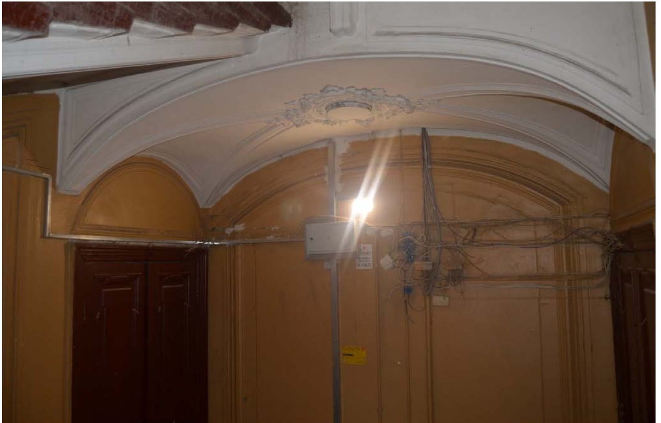
33. Выявленный объект культурного наследия «Дом Сироткиных». Парадная лестница (Л1). Оформление потолка и стен этажной площадки третьего этажа. Вид с юга. Съемка 26.04.2021
